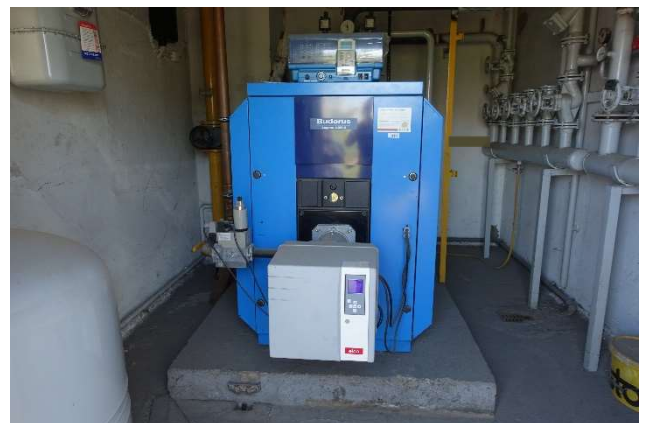
7.3.24 Heizungsanlage im Erdgeschoss der Halle I
