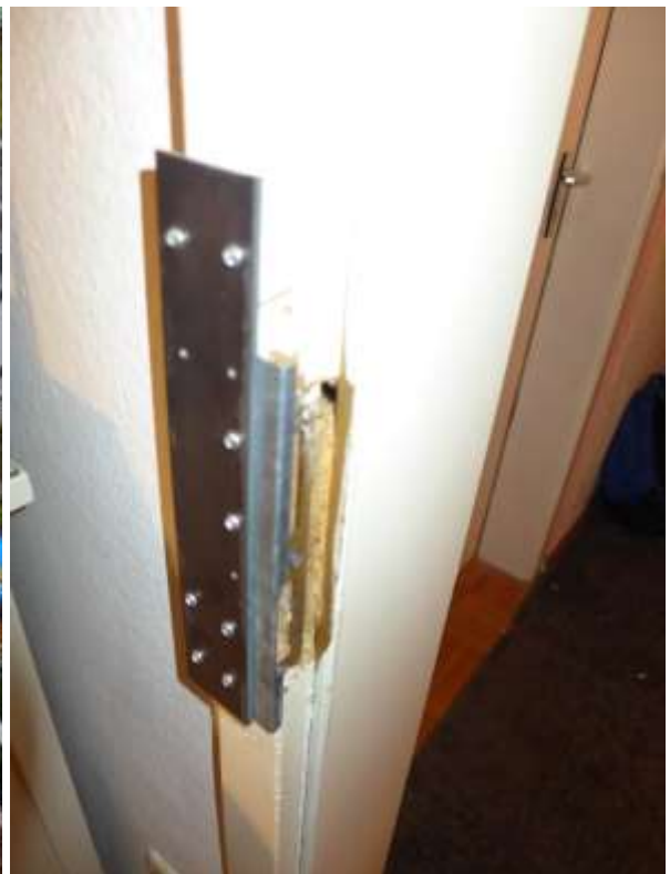
18 b schadhafte Wohnungseingangstür EG
