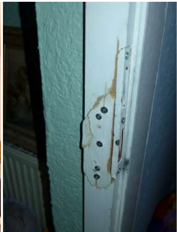
14 b schadhafte Wohnungseingangstür DG
