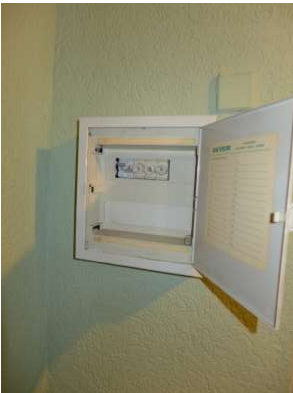
16 a Elektroverteilung Wohnung DG
