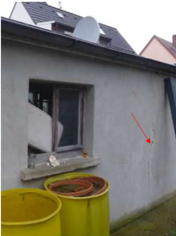
22 Rissbildung hintere Garage
