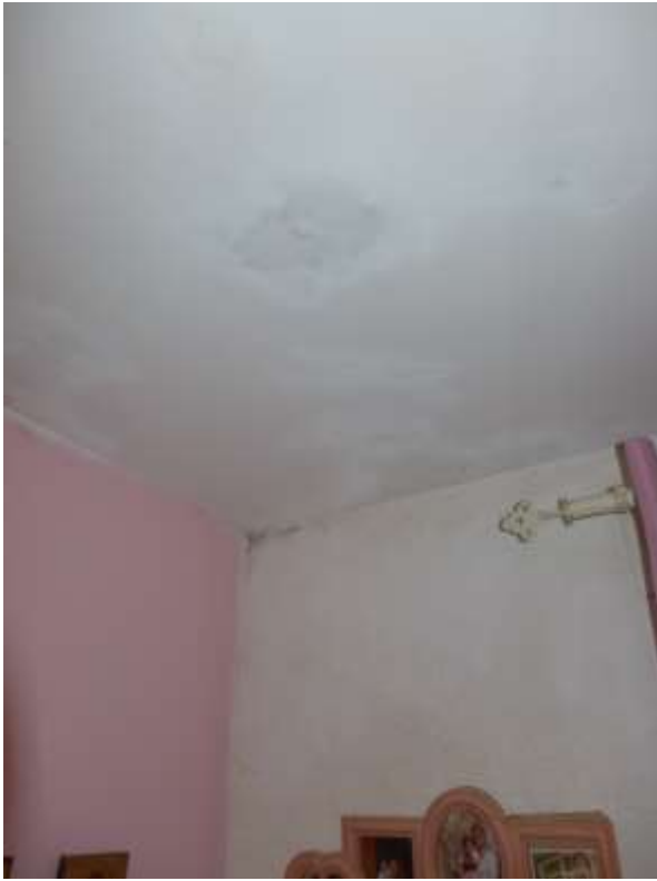
21 a Feuchtigkeitsflecken, Schimmel in Ecke
