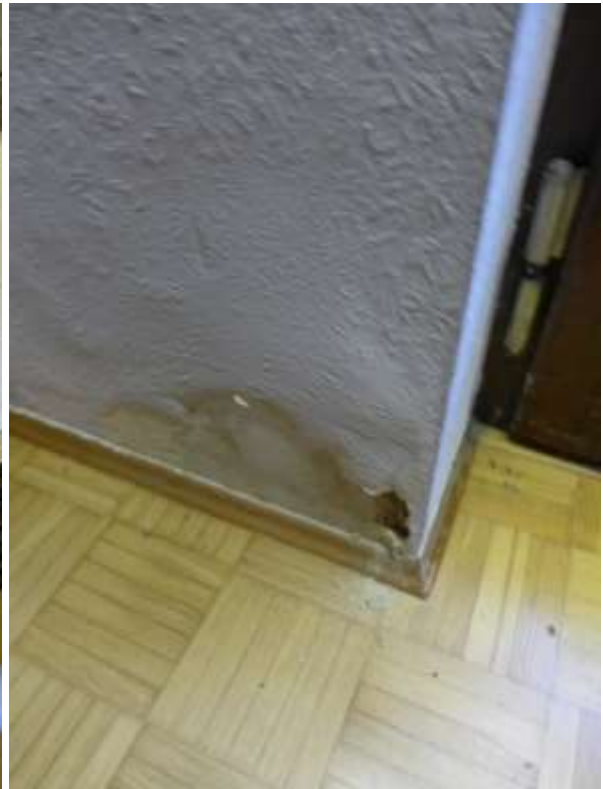
13 b Feuchteschaden am Terrassenausgang
