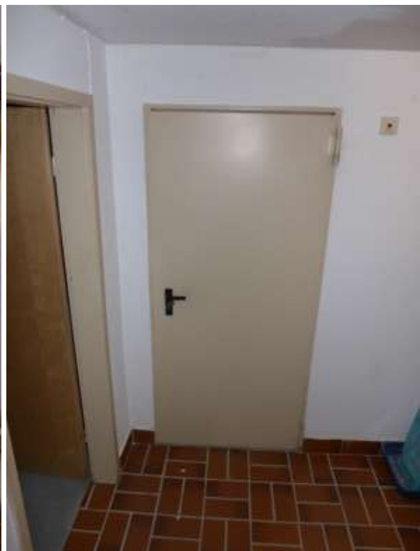
8 b FH-Tür zum Heizungsraum
