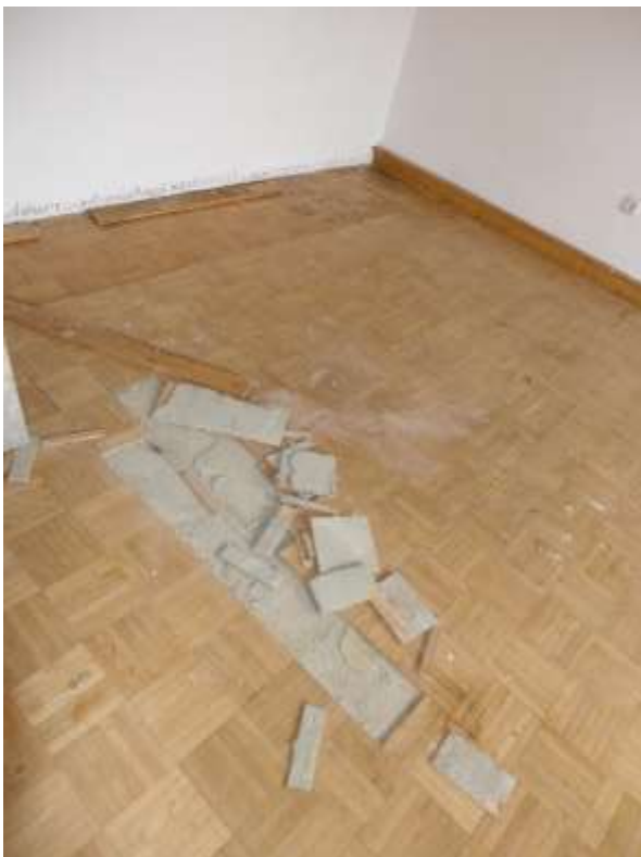
22 a defekter Parkettboden/Estrich 4. OG
