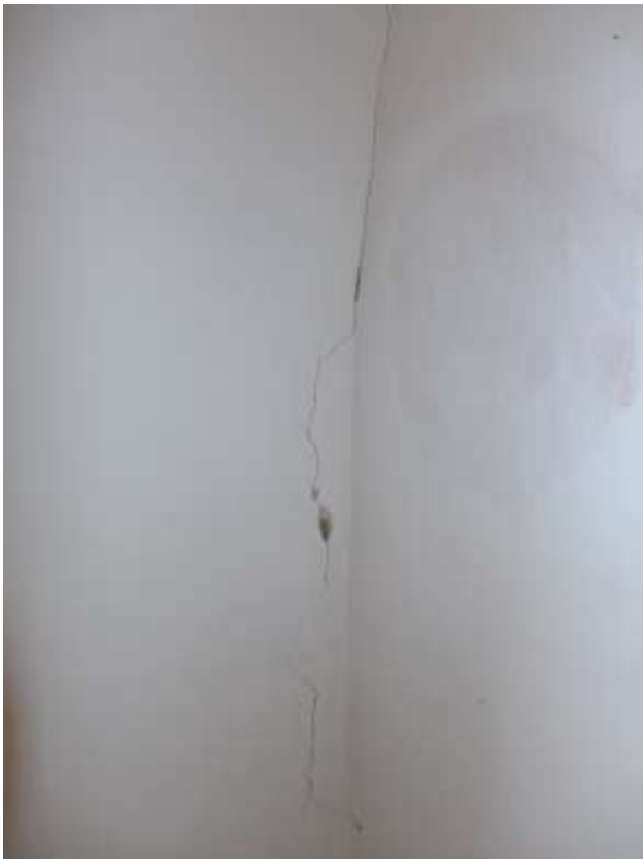
23 a Riss 4. OG
