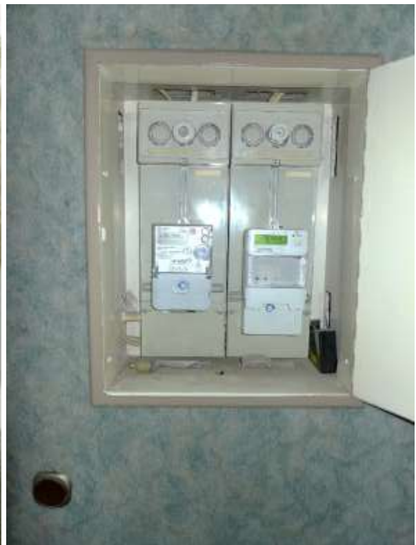
18 b Stromzähler im Treppenhaus 2. OG
