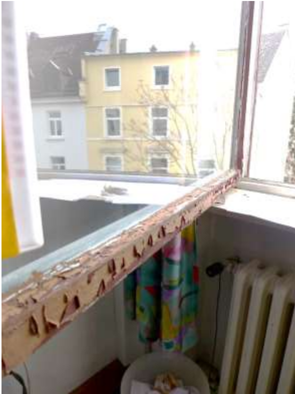
27 Zustand Fenster 4. OG
