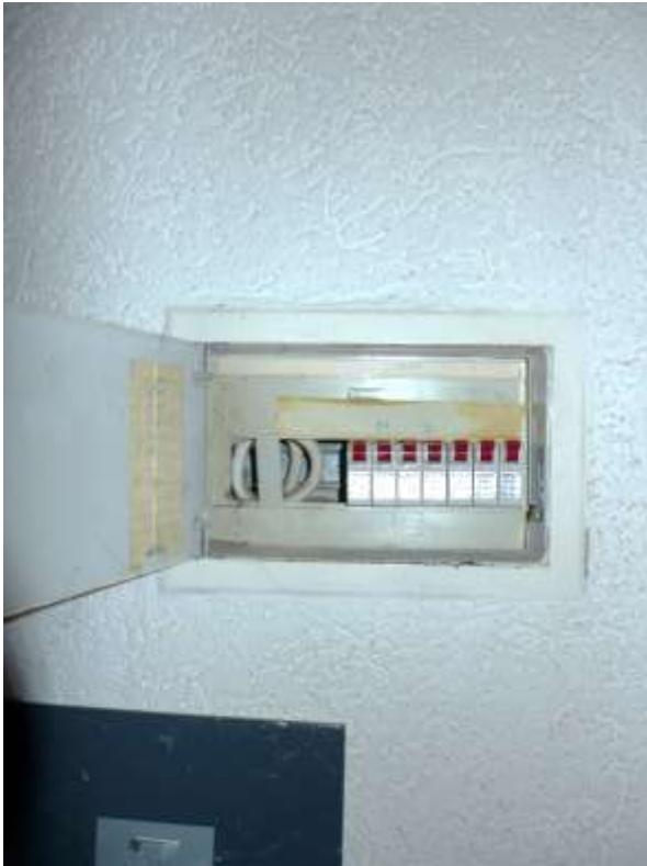
21 a Sicherungskasten 4. OG
