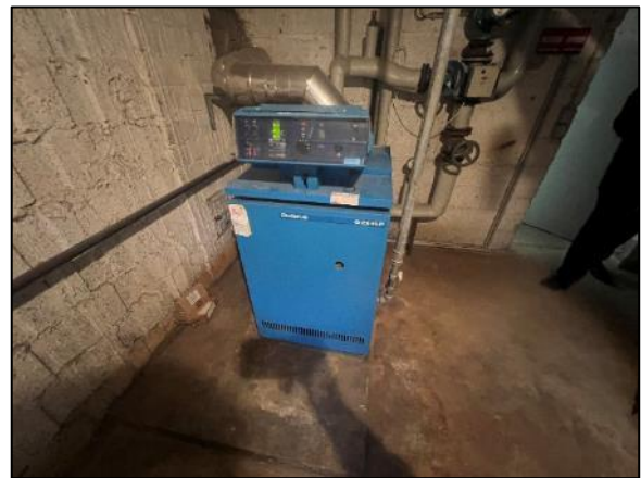
Heizungsanlage im Kellergeschoss
