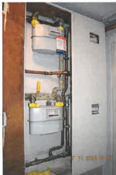
Gasuhren im Kellerflur
