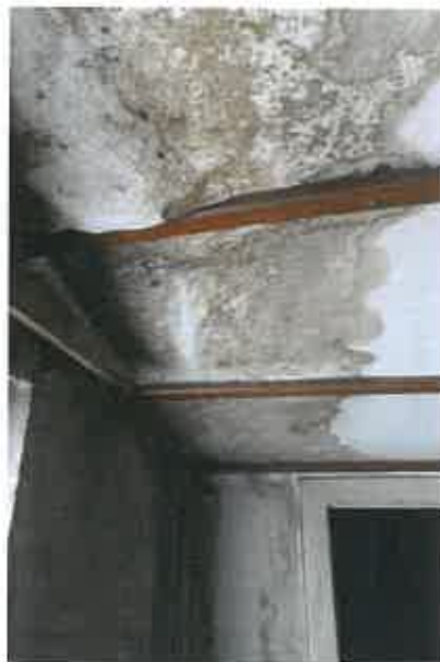
alte Nässeschäden durch Brandbekämpfung
