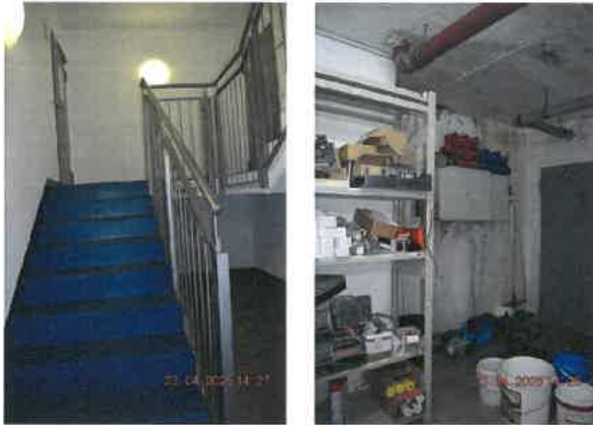
Treppe zum Untergeschoss 3. UG Lagerraum mit sichtbaren Nässeschäden
