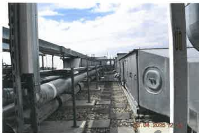
Kühlregister auf dem Dach
