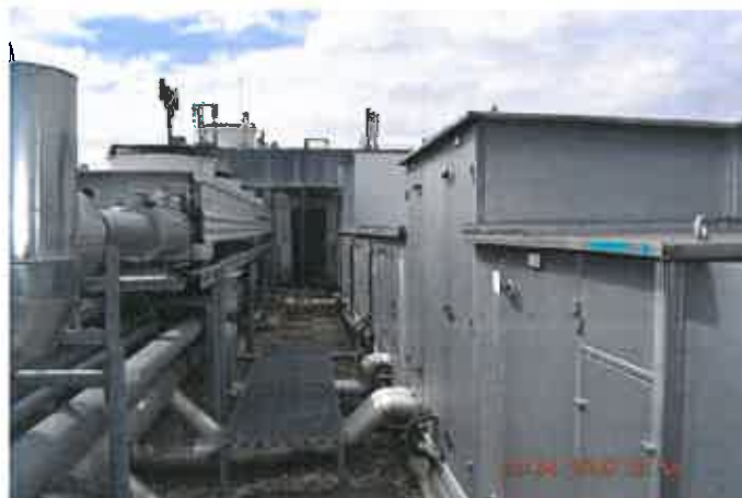
Kühlregister auf dem Dach
