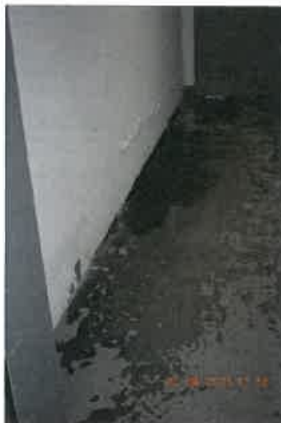
sichtbare Nässeschäden 2. Untergeschoss
