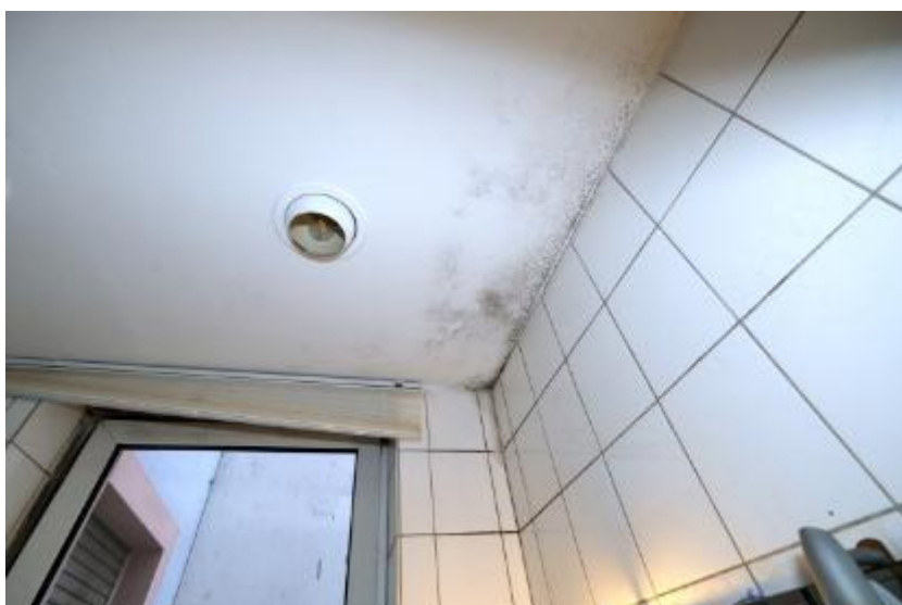
39) Massive Sporenbildung / Schwarzverfärbung im Decken- und Fensterlaibungsbereich.
