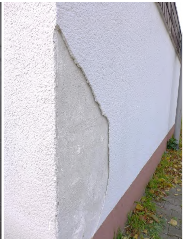
14 b Putzschäden Garage
