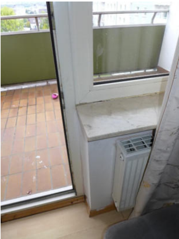
16 a Fenster, Boden, Heizkörper
