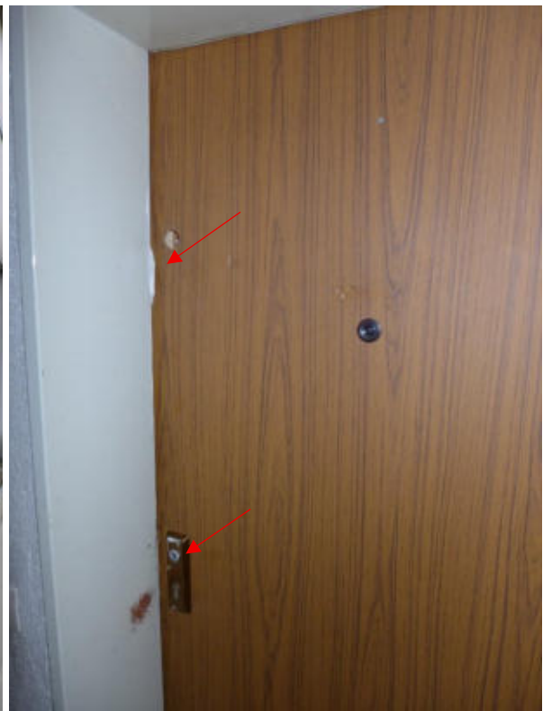
18 b beschädigte Wohnungseingangstür
