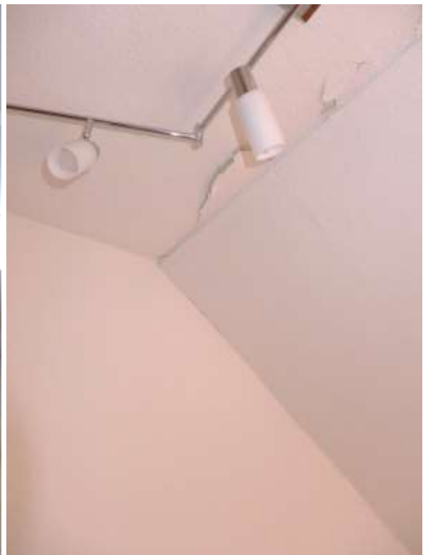
18 b typische Dachgebälkspannungsrisse
