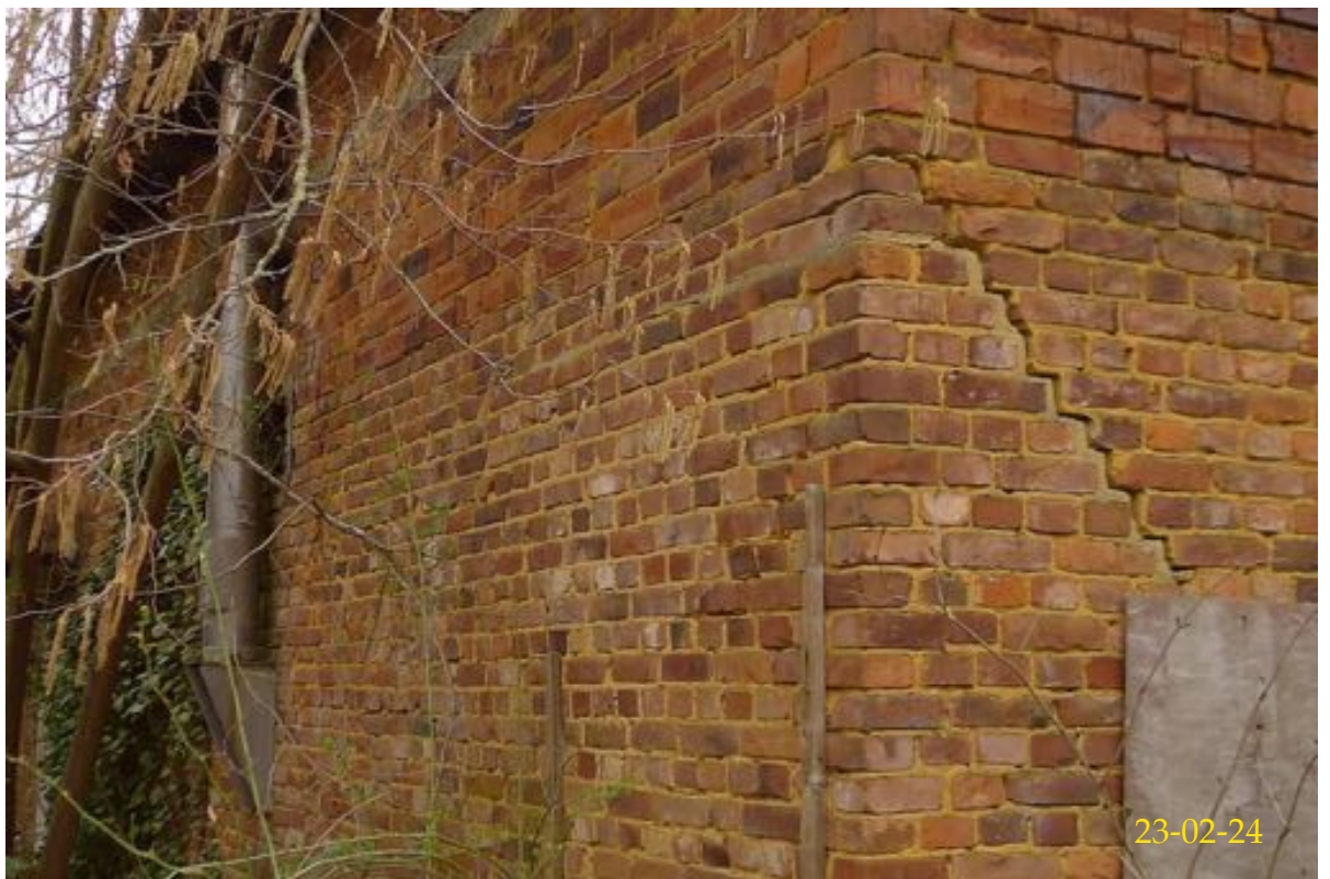
Werkstattgebäude - Hausecke Süd-Westen starker Setzungsrisse
