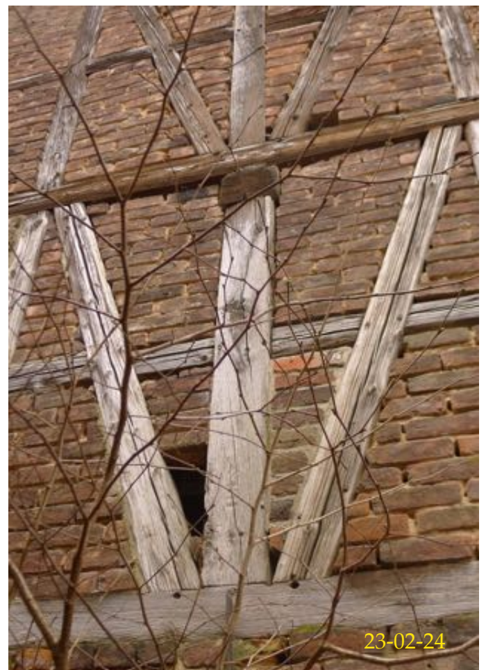
Scheune - Giebel Süd-Westseite Ausmauerung der Gefache schadhaft
