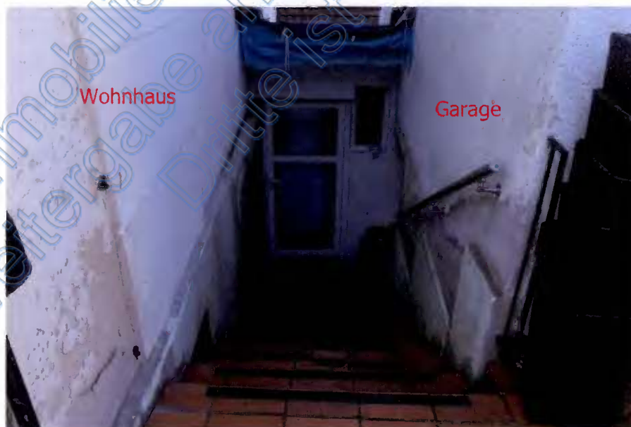
Foto 6 Zwischenbau ohne Genehmigung
