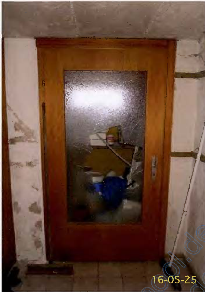
Kellergeschoss - Tür zum Abstellraum 1 Glasscheibe defekt
