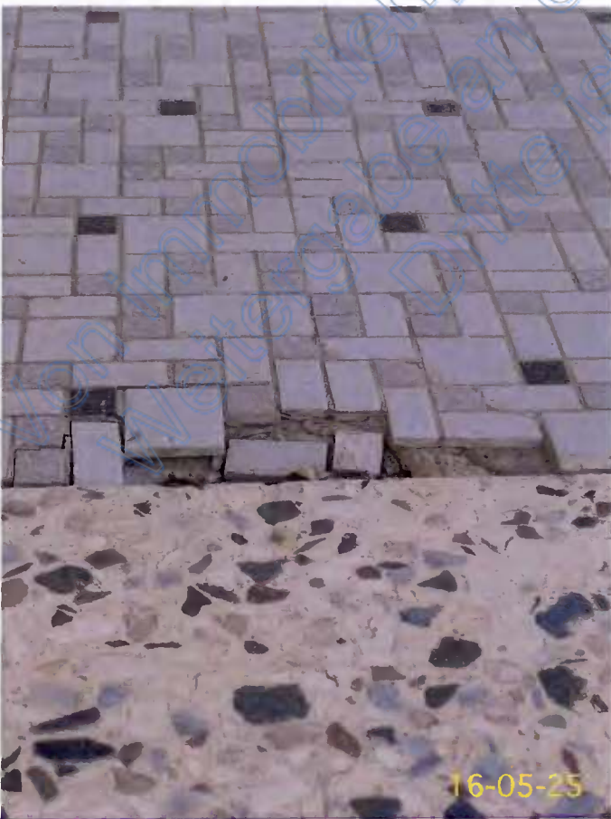
Eingangspodest Mosaikfliesen ausgefallen
