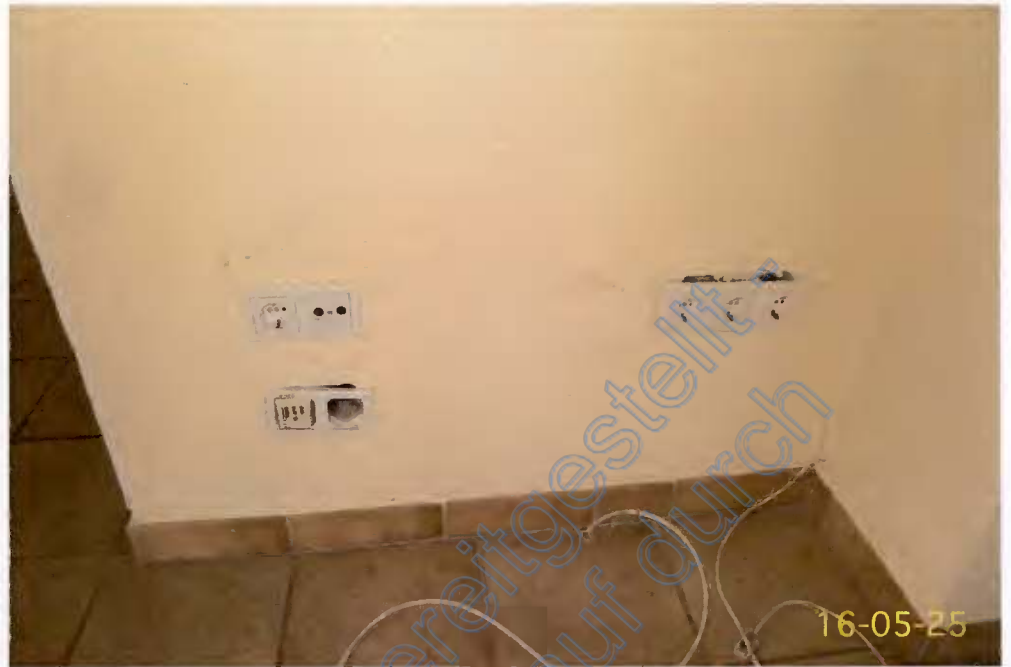
Erdgeschoss Wohnung Wohnzimmer Steckdosen locker
