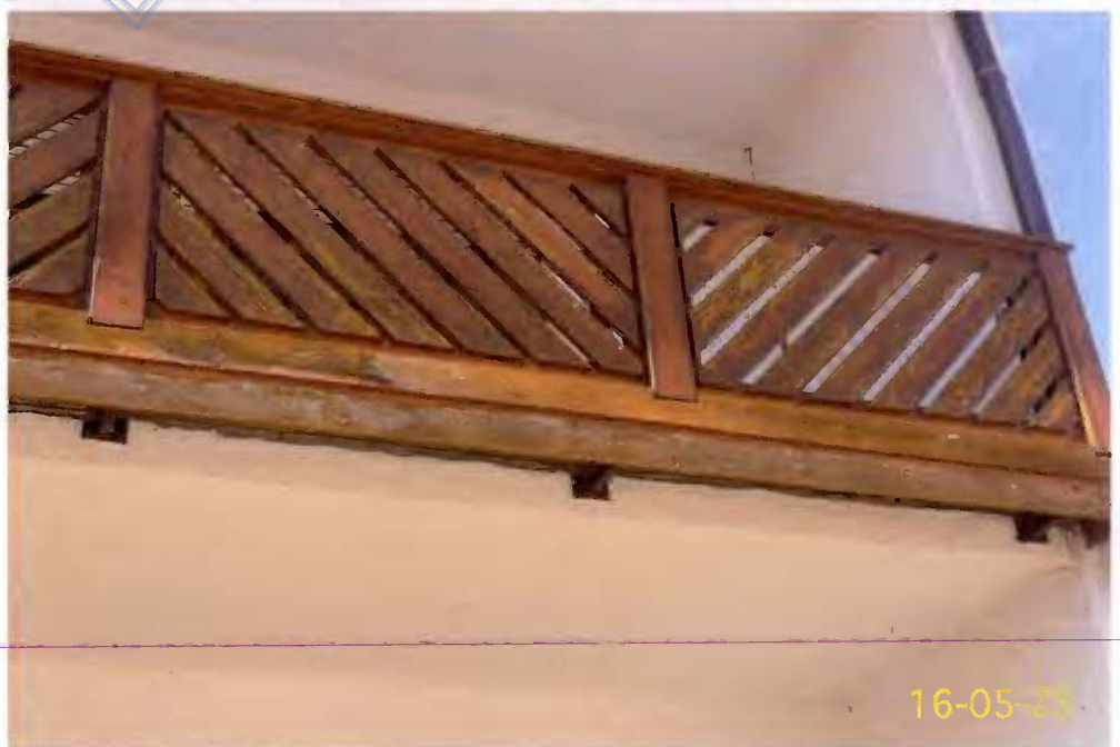
Ansicht Balkongeländer Anstrich blättert ab
