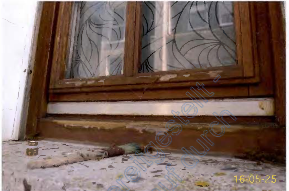
Detailansicht Holzfenster Anstrich blättert ab
