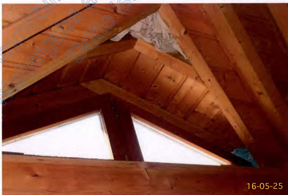
Obergeschoss - zur Wohnung im OG - Etagenpodest undichte Stelle in der Dachschräge
