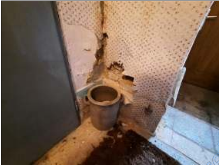
Abb. 10: Keller, Schadstellen Feuchtigkeit
