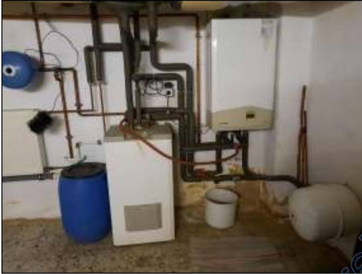
Abb. 13: Keller – Heizung (außer Funktion)
