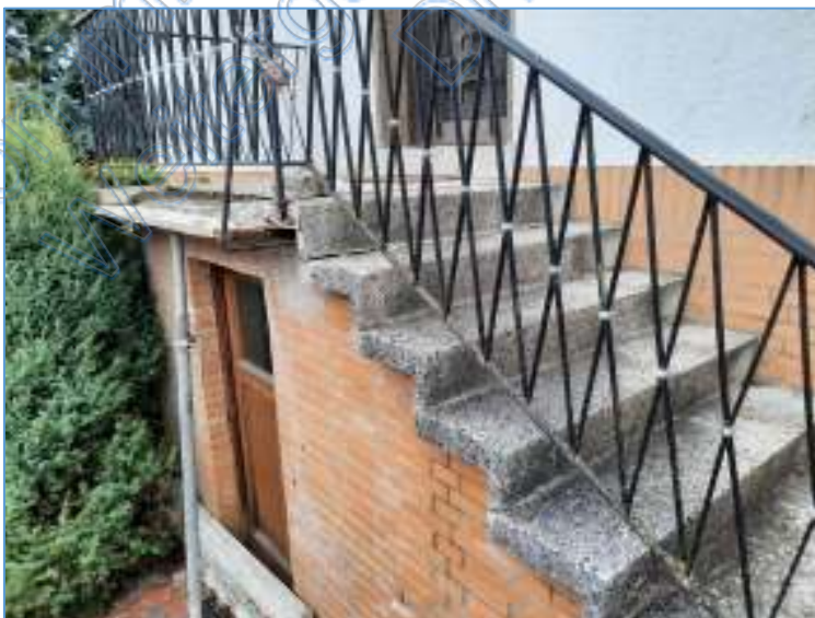
Abb. 9: Schadstellen an Eingangstreppe
