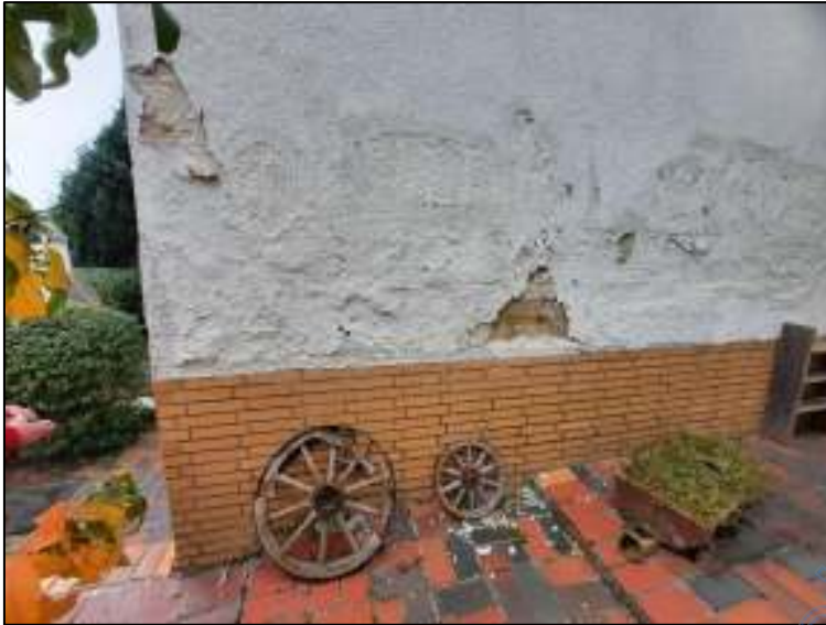
Abb. 16: Flurstück 65/1 mit Garagen, Putzschäden
