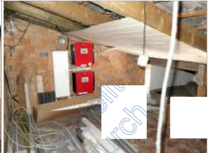
Bild 38: Raum üb. Garage | Wechselrichter
