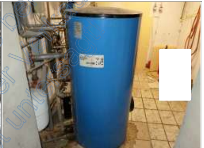
Bild 34: Kellerbereich | Warmwasserspeicher 200l
