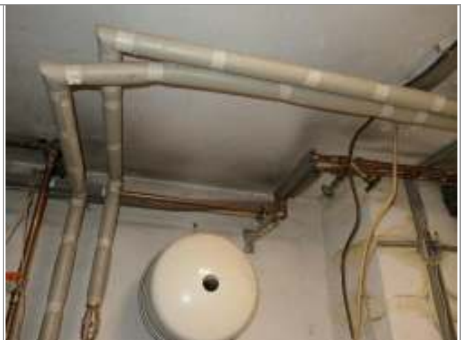
Bild 36: Kellerbereich | Rohrführungen (exemplarisch)
