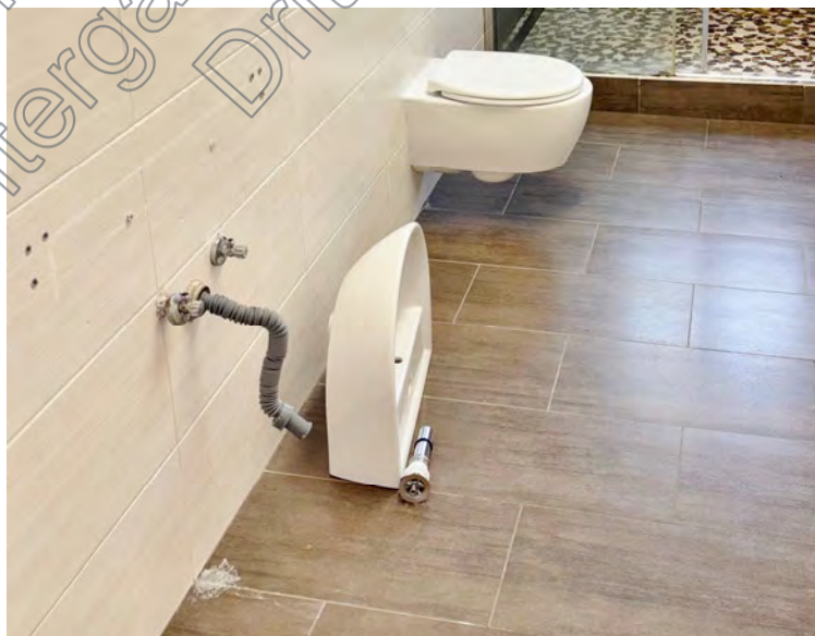
Foto Nr. 12 defektes Waschbecken
