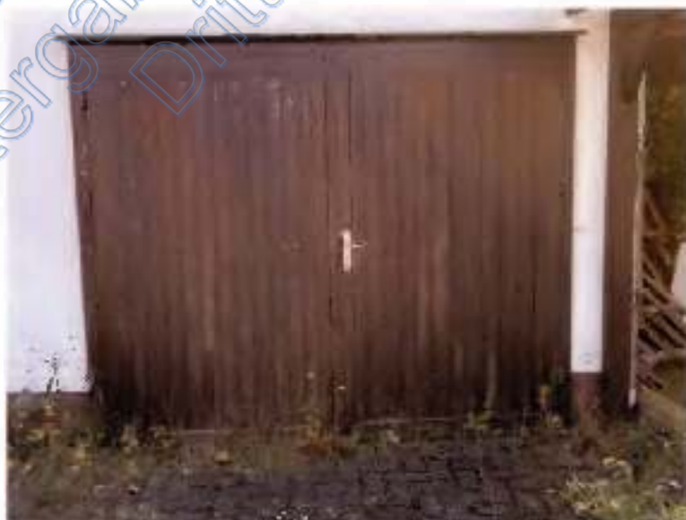
Foto Nr. 19 Holzschutzmangel Garagentor KG
