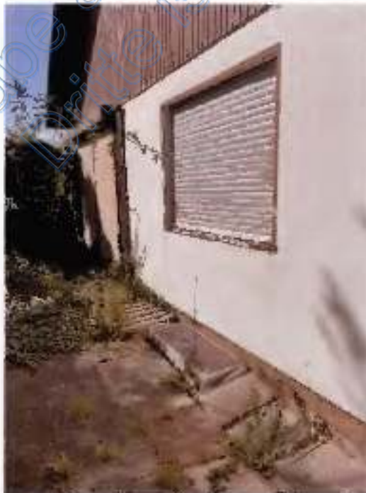
Foto Nr. 17 schadhafter Plattenbelag Gebäudesüdseite
