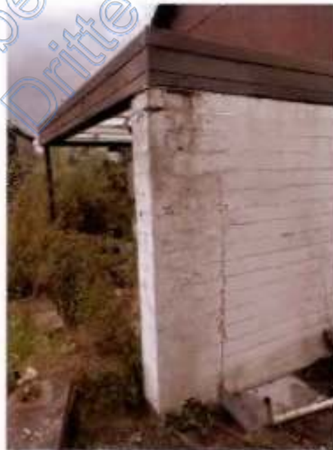
Foto Nr. 21 schadhafte Mauerwerksauflage Terrassenüberdachung
