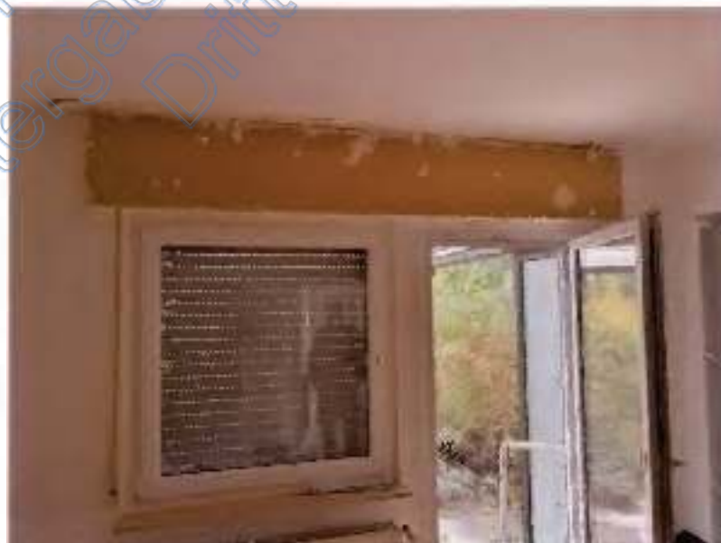
Foto Nr. 23 schadhafte Rolllkastenverkleidung Gästezimmer EG
