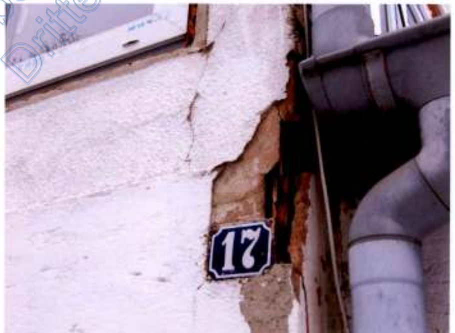
Ansicht Anschluss- bereich dreigeschos- siger Baukörper zum eingeschossigen östlichen Anbau mit erheblichen Feuchtig- keitsschäden als Beispiel von Süden
