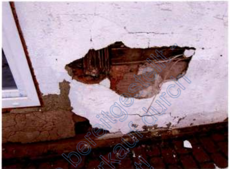
Ansicht Sockelbereich dreigeschossiger Baukörper mit erheb- lichen Feuchtigkeits- schäden als Beispiel von Süden
