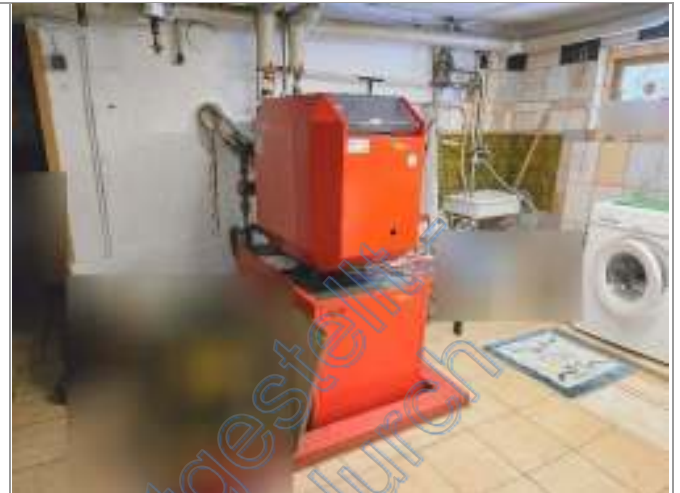
Bild 32: Bj. 1966 / KG | Waschküche mit Heizung
