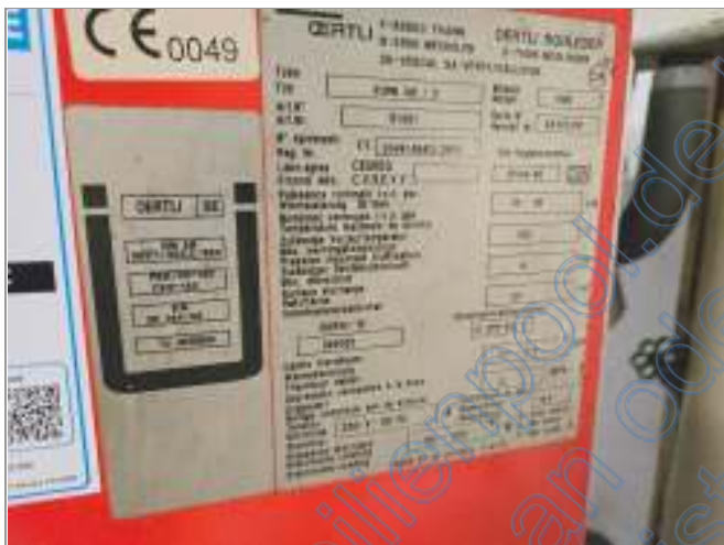
Bild 33: Bj. 1966 / Öl-Niedertemperaturheizung Fabrikat Oertli-Rohleder, Baujahr 1998
