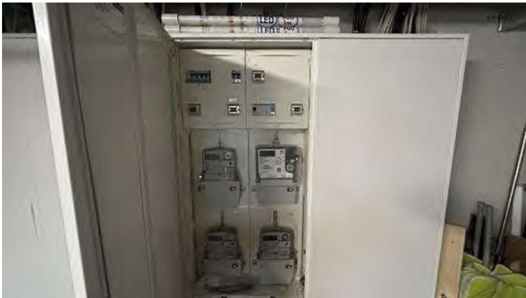
Bild D1 Beispiel Haustechnik
