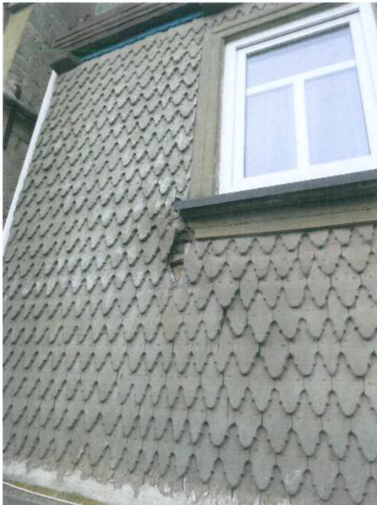
Bild 14, Wohnhaus Fassadenbe- kleidung, Schäden an Holzschindeln
