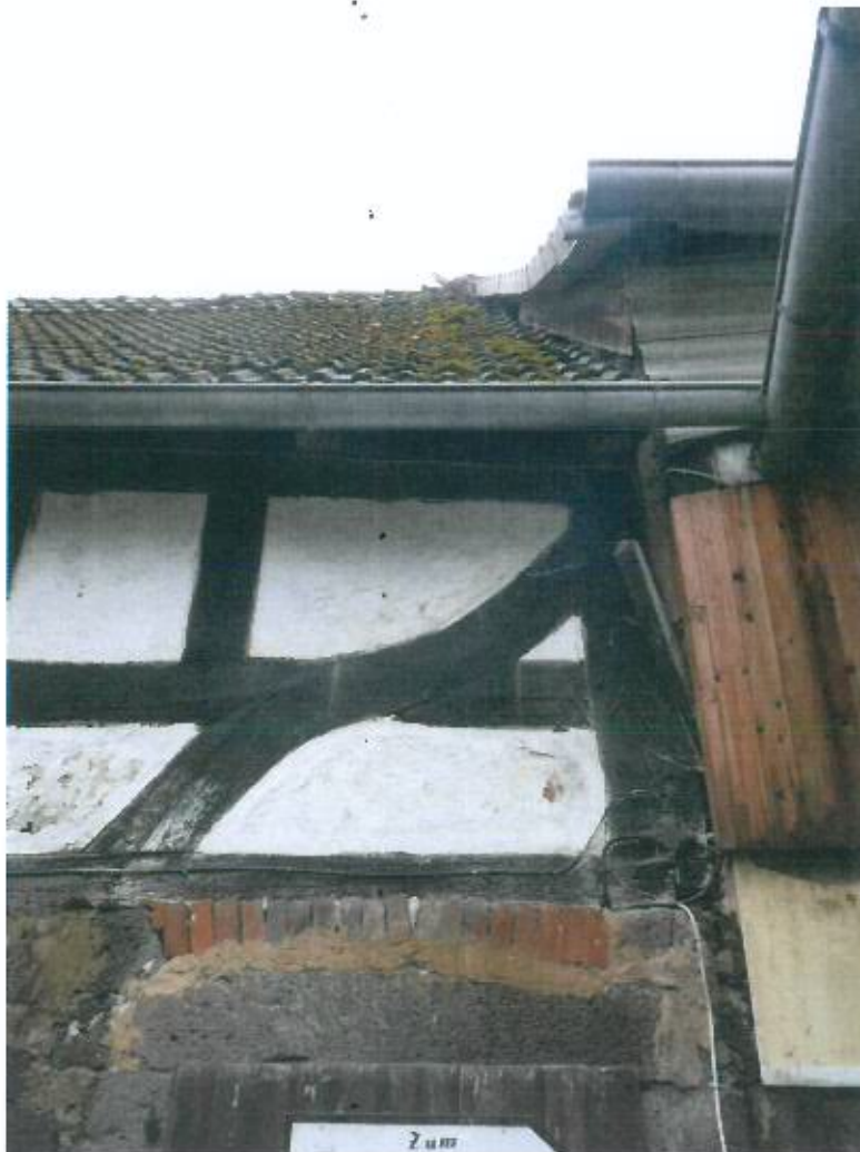
Bild 8, Scheune, Schäden Fassade
