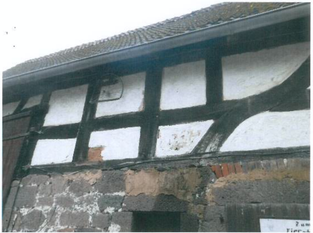
Bild 7, Scheune, Schäden in der Fassade
