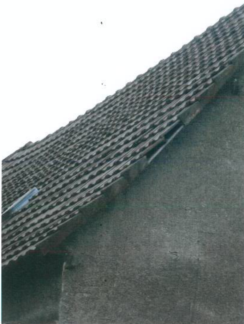
Bild 6, Scheune, Schäden am Ortgang
