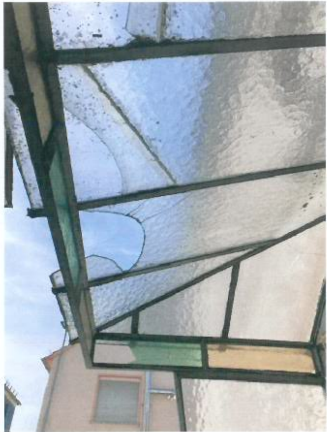
Bild 9: Schäden an der Eingangsüberdachung
