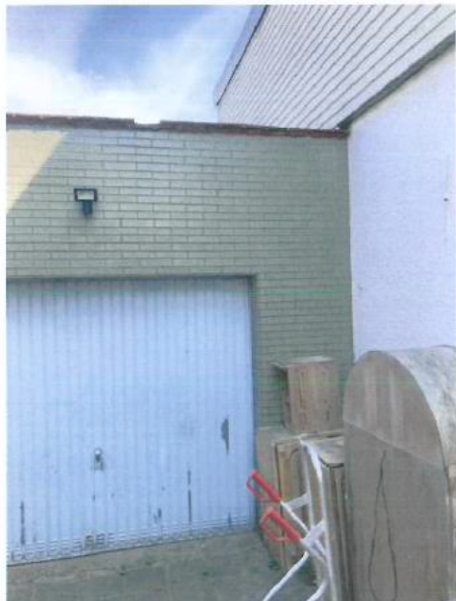
Bild 10: Schäden an der Attika der Garage
