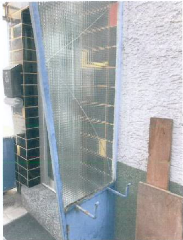
Bild 8: Schäden an der Eingangsüberdachung
