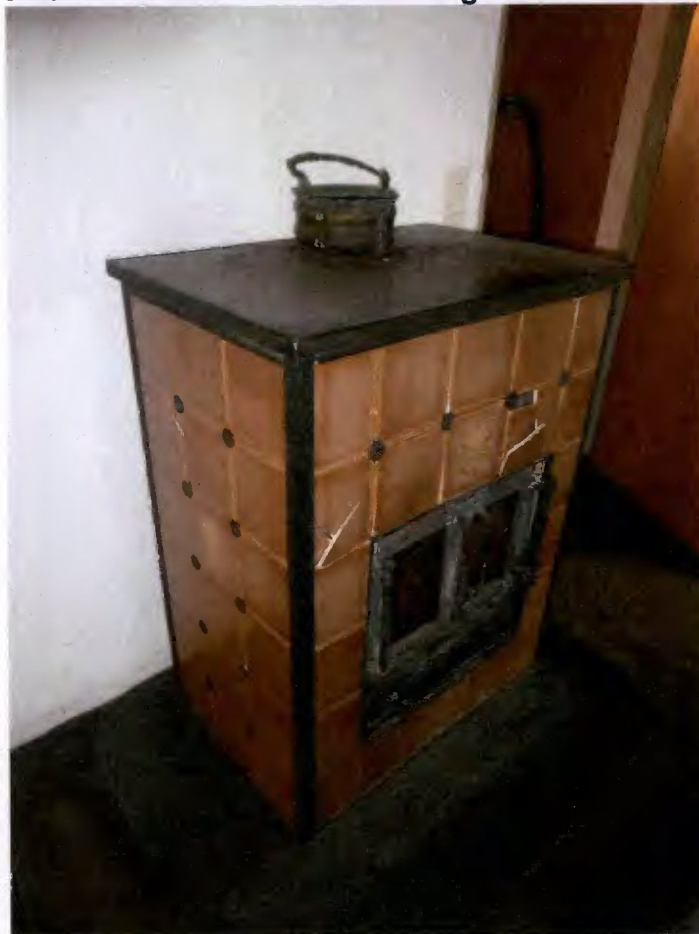
Bild 12 Erdgeschoss, Kachelkamin, Schäden in der Bekleidung
