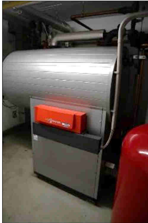
Bild D1: Beispiel Haustechnik
