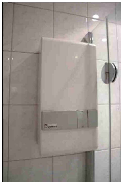
Bild D4: Beispiel Haustechnik
