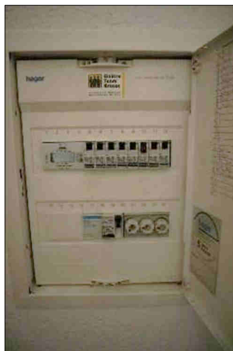
Bild D6: Beispiel Haustechnik
