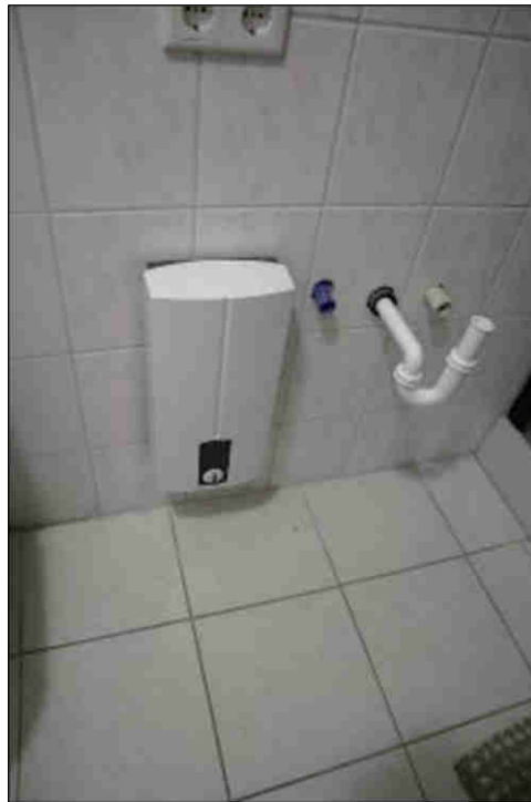
Bild D3: Beispiel Haustechnik
