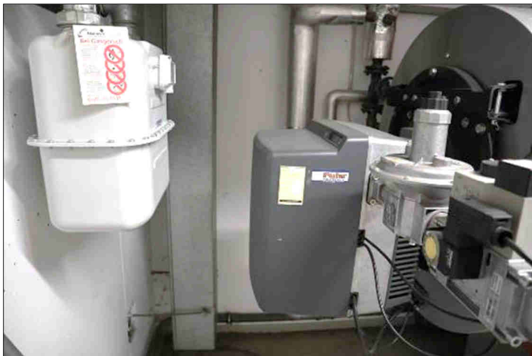
Bild D2: Beispiel Haustechnik
