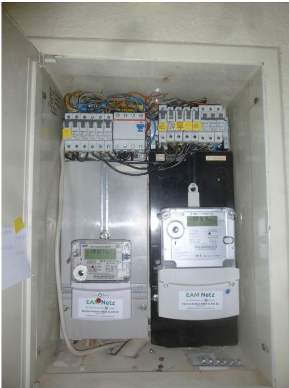
Bild 3: Ansicht Stromverteilung / Elektrik:
