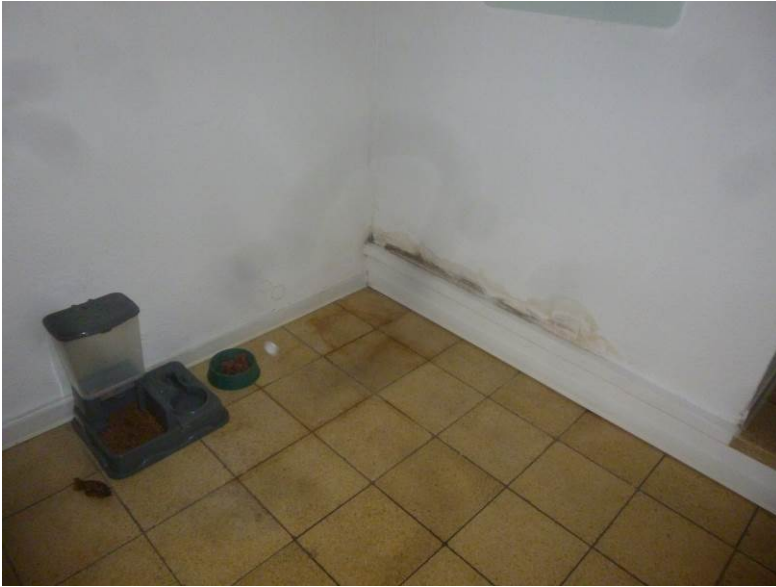
Bild 9: Ansicht Feuchtigkeit / Schimmel Verkaufsraum EG:
