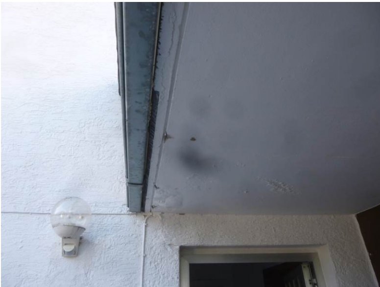
Bild 8: Ansicht Folgeschaden Terrasse:
