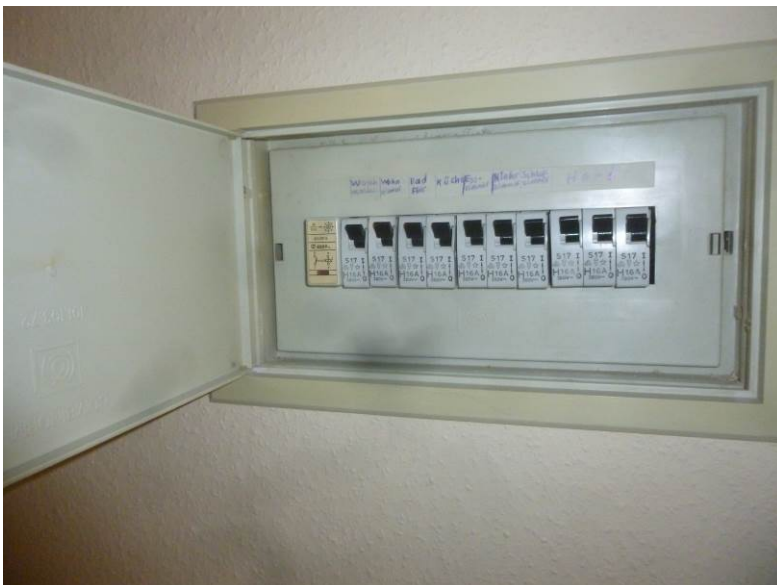
Bild 4: Ansicht Stromverteilung der Wohnung:
