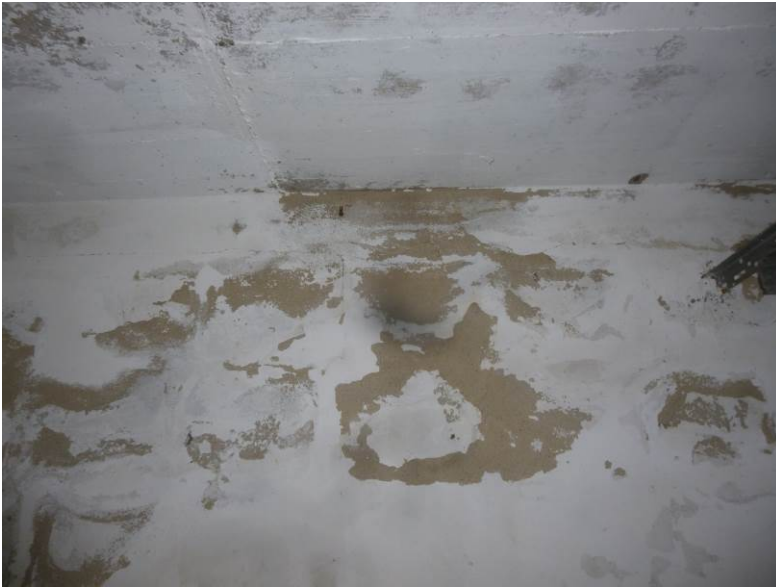
Bild 9: Ansicht Feuchtigkeit Garage:
