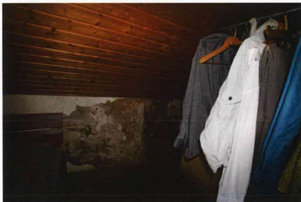
Feuchteschäden im DG durch undichtes Dach (repariert)
