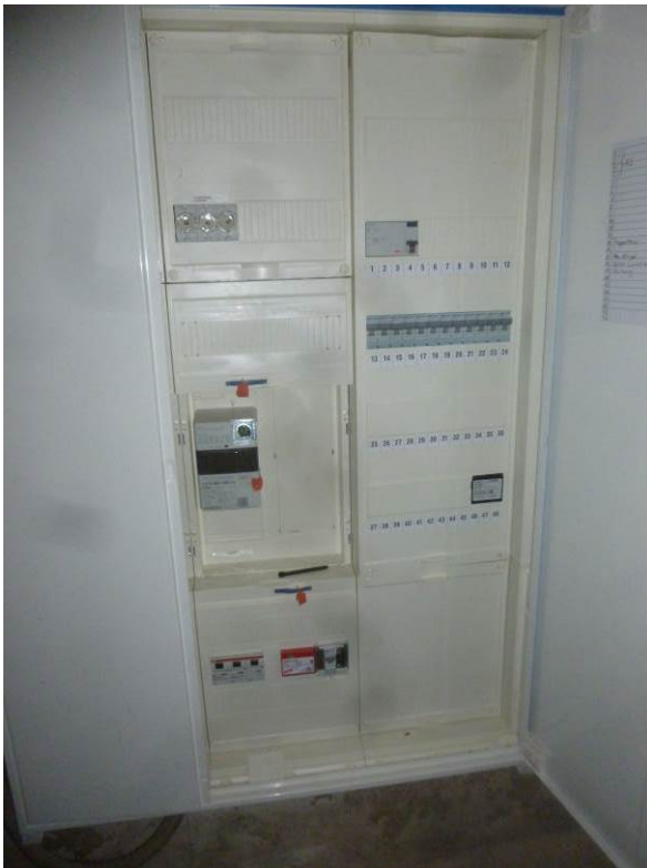
Bild 3: Ansicht Stromverteilung / Elektrik:
