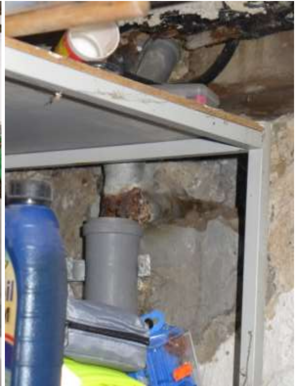
11 b defekte Abwasserleitung (verm. Bleirohr)
