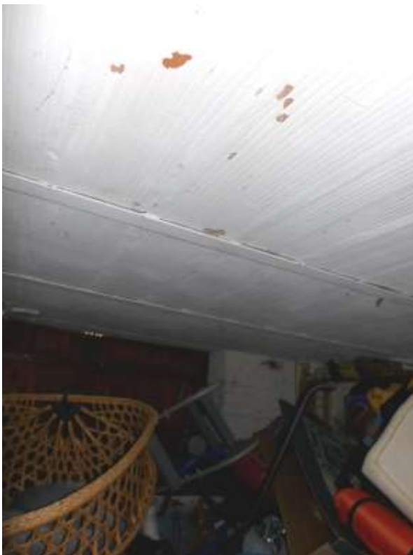
16 Decke Remise Bereich Kinderzimmer
