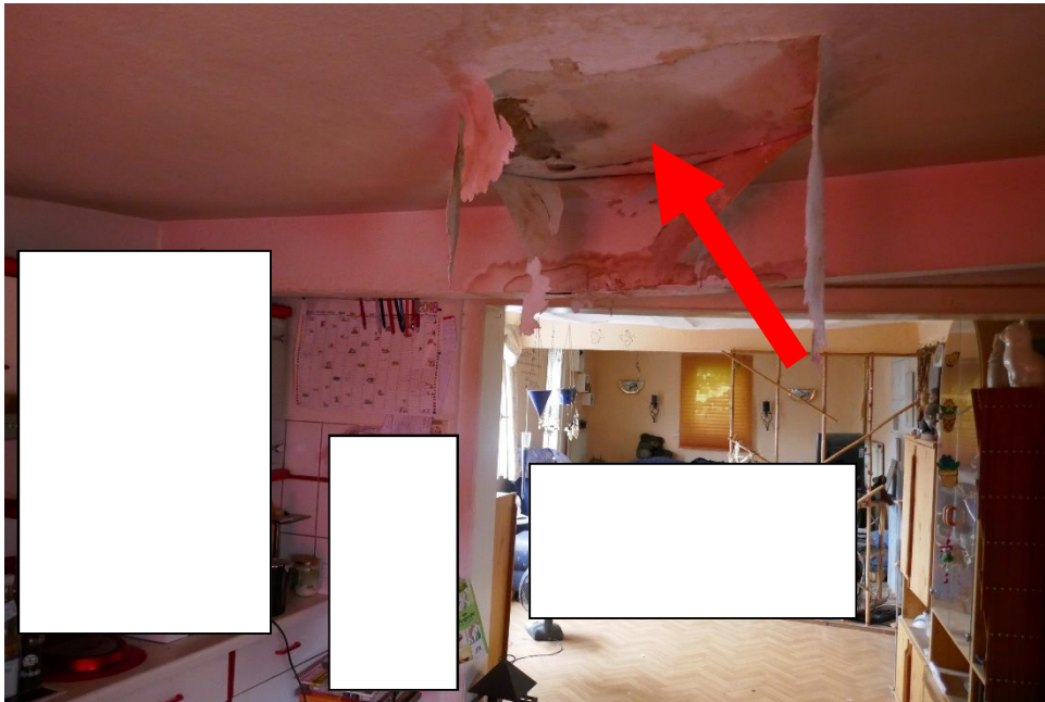
Bild_27_“Wasserschaden in der Küche (EG)”
