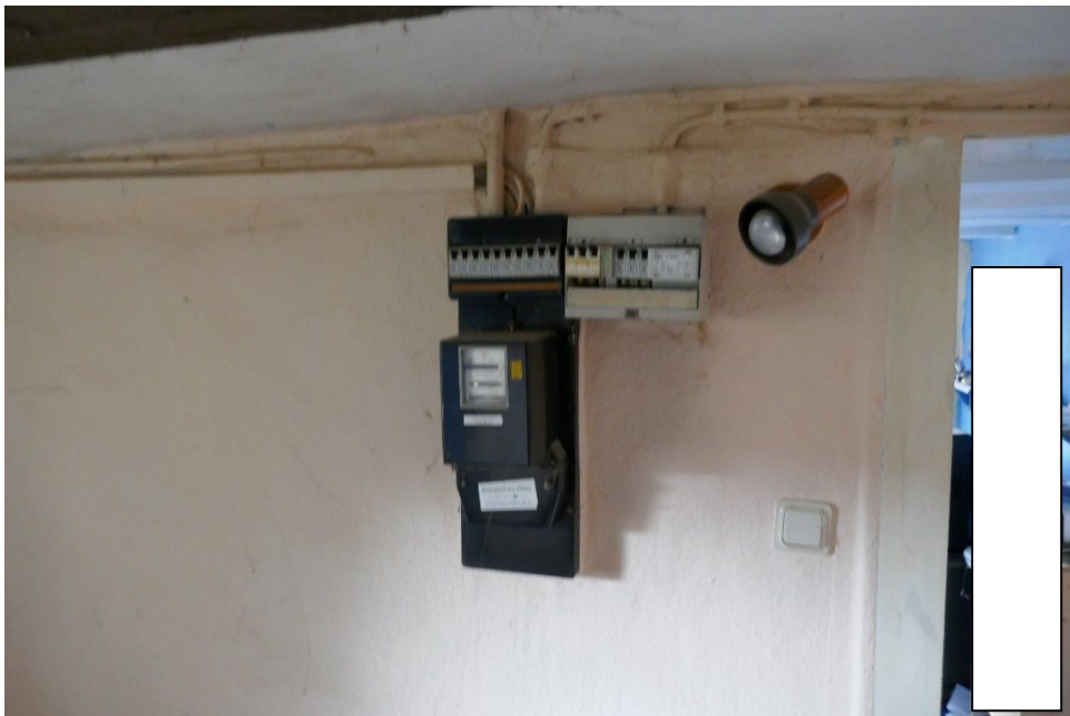
Bild_32_“Stromzähler im Flur (OG)“
