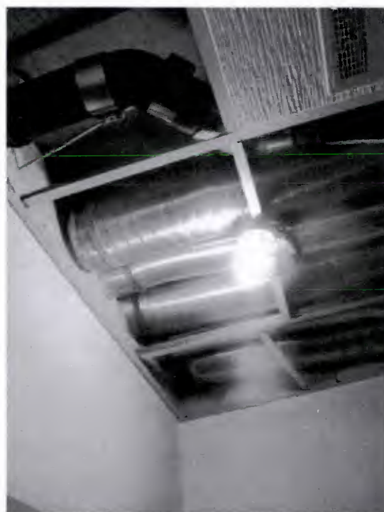
Fertigstellungsbedarf im Deckenbereich
