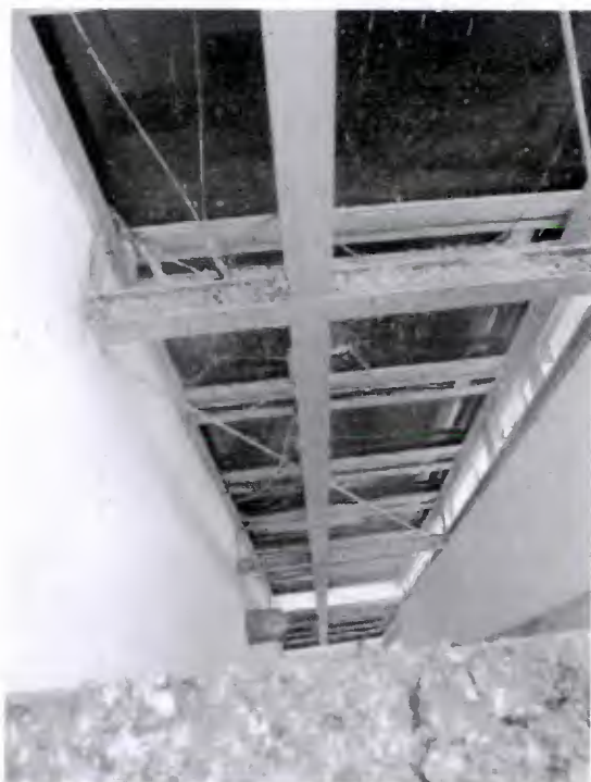
PV-Anlage vor Fenster!
