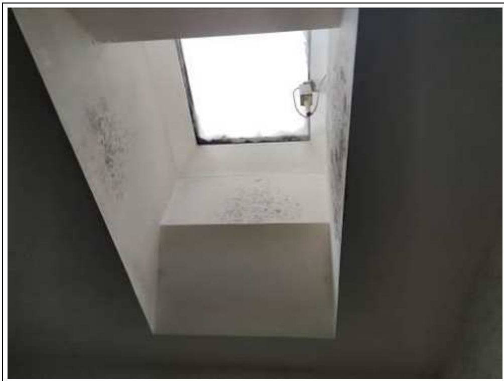
Blick auf kaputte Dachlichtkuppel
