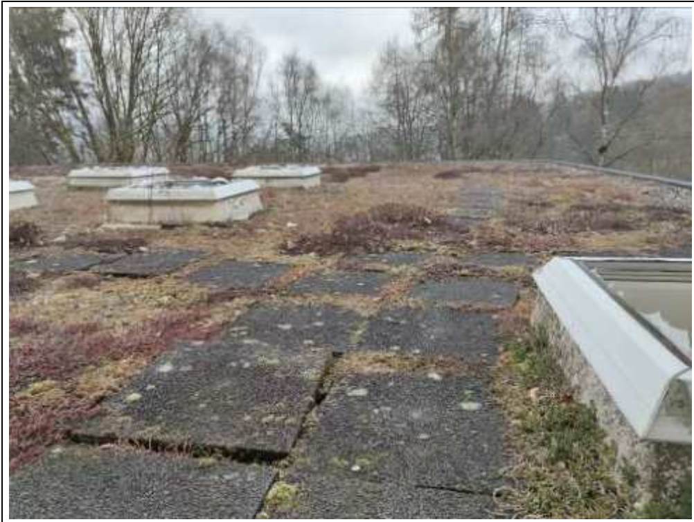
Blick auf das Flachdach mit kaputten Lichtkuppeln
