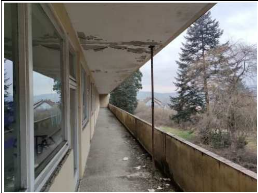
Blick auf den Balkon mit Notabstützung
