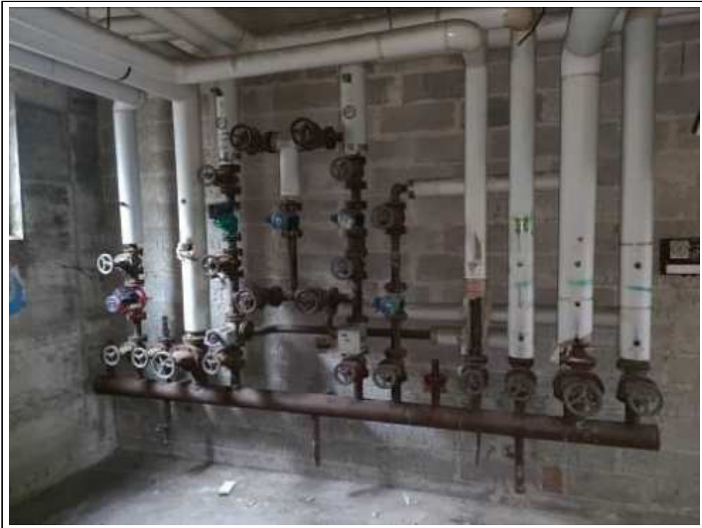
Blick auf die Heizungsverteilung
