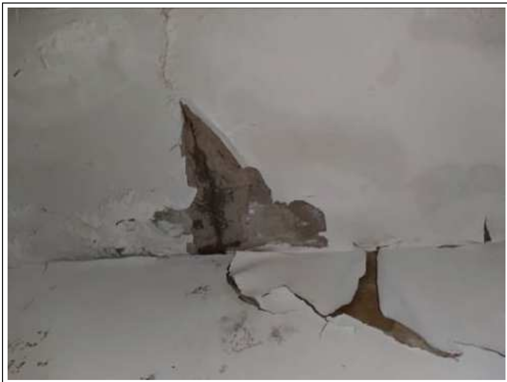
Blick auf Risse und Feuchtigkeitsschäden
