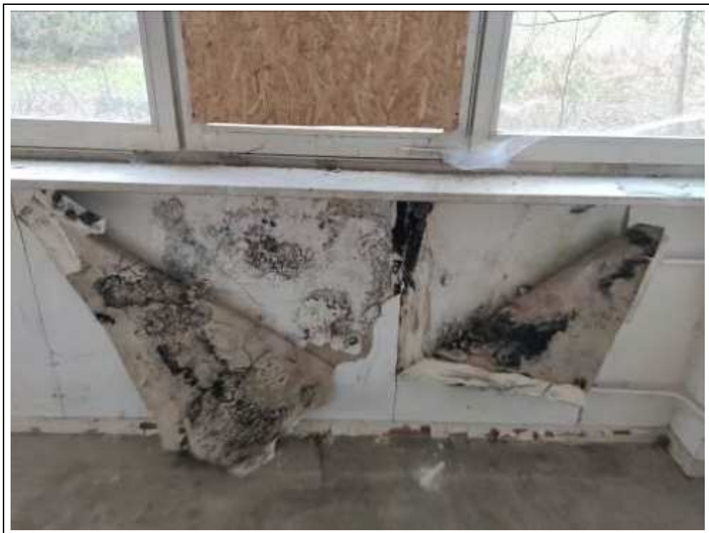
Blick auf Schimmelschäden an den Außenwänden
