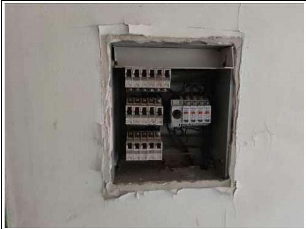
Blick auf einen Sicherungskasten
