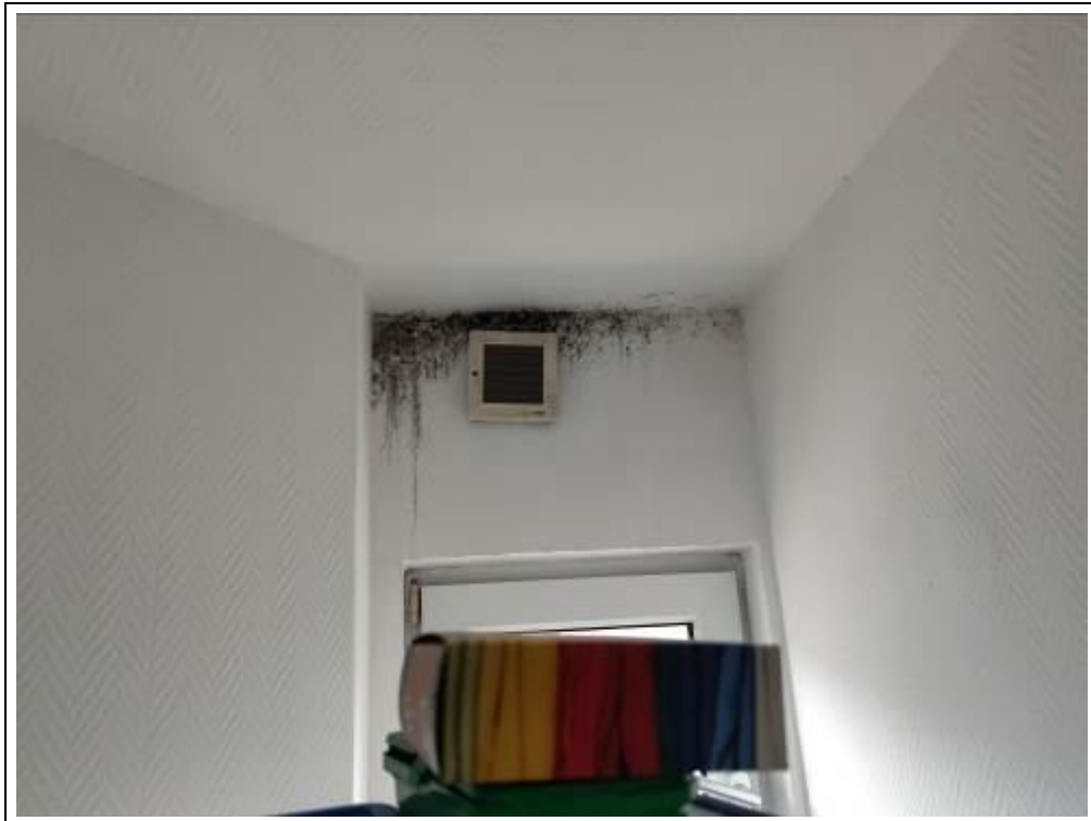
Blick auf Schimmelpilzschaden in der Dusche im Dachgeschoss
