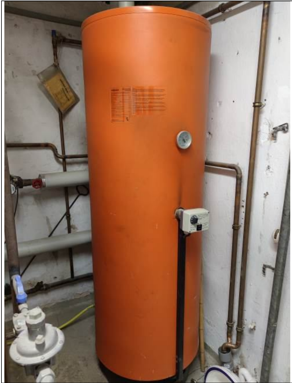
Blick auf den 400 Liter Warmwasserspeicher
