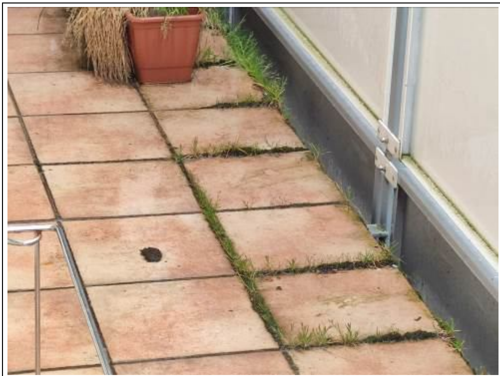
Blick auf den Zustand der Balkonfliesen beim Balkon im Dachgeschoss
