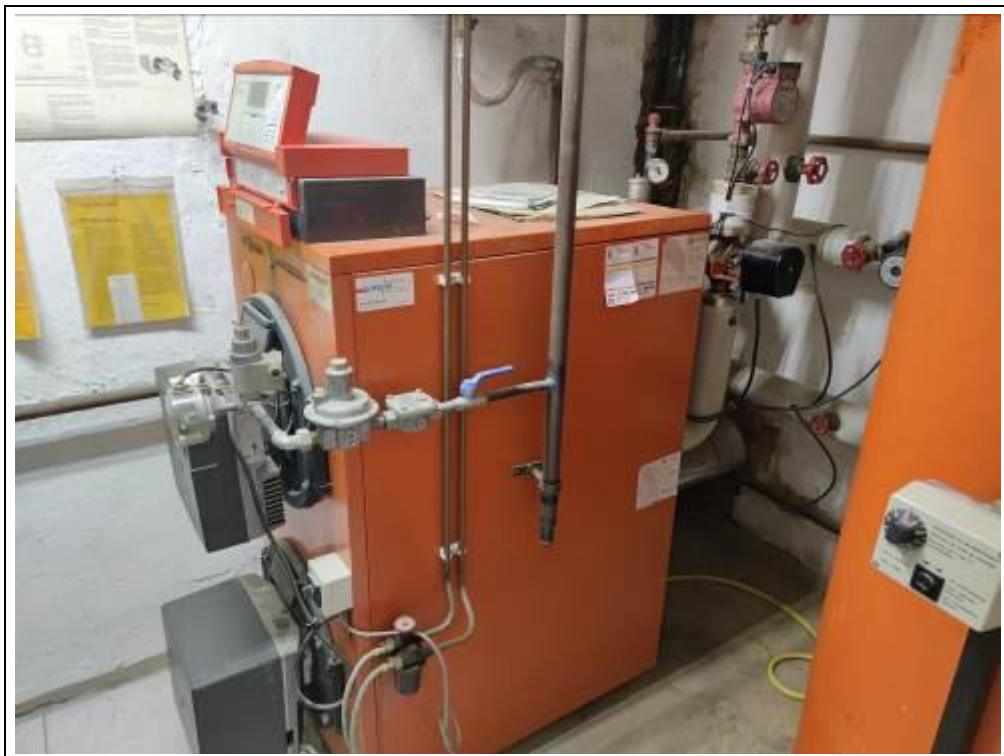
Blick auf die Heizungsanlage
