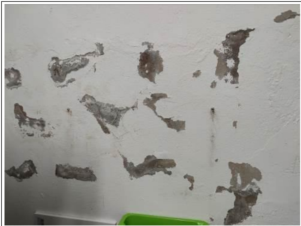
Blick auf Putz- und Feuchtigkeitsschäden im Kellergeschoss
