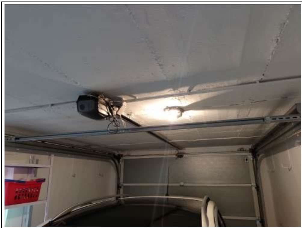
Blick in die Garage mit elektrisch angetriebenem Garagentor
