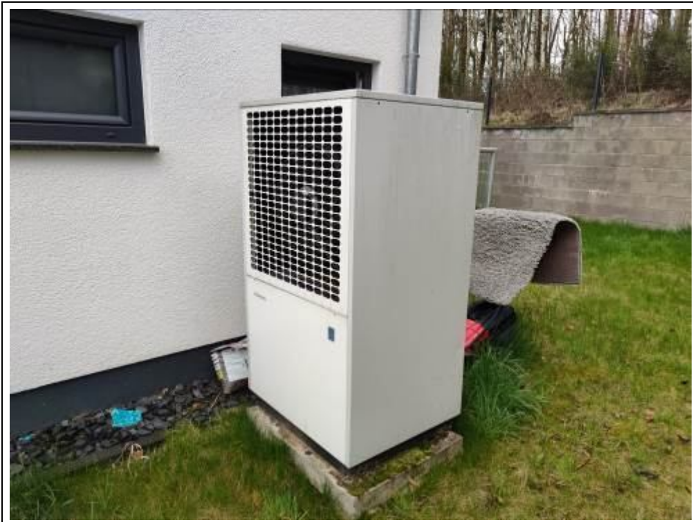
Blick auf die Wärmepumpe als Heizungsanlage
