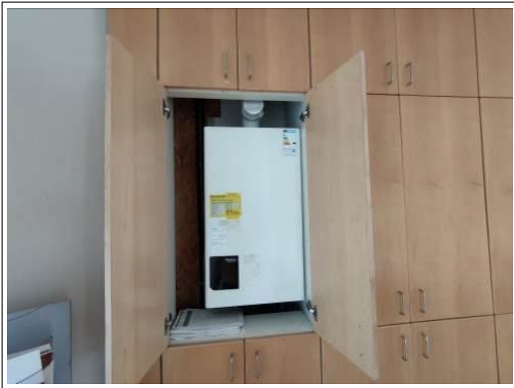
Blick auf die Gastherme in einem Schrank im Dachgeschoss
