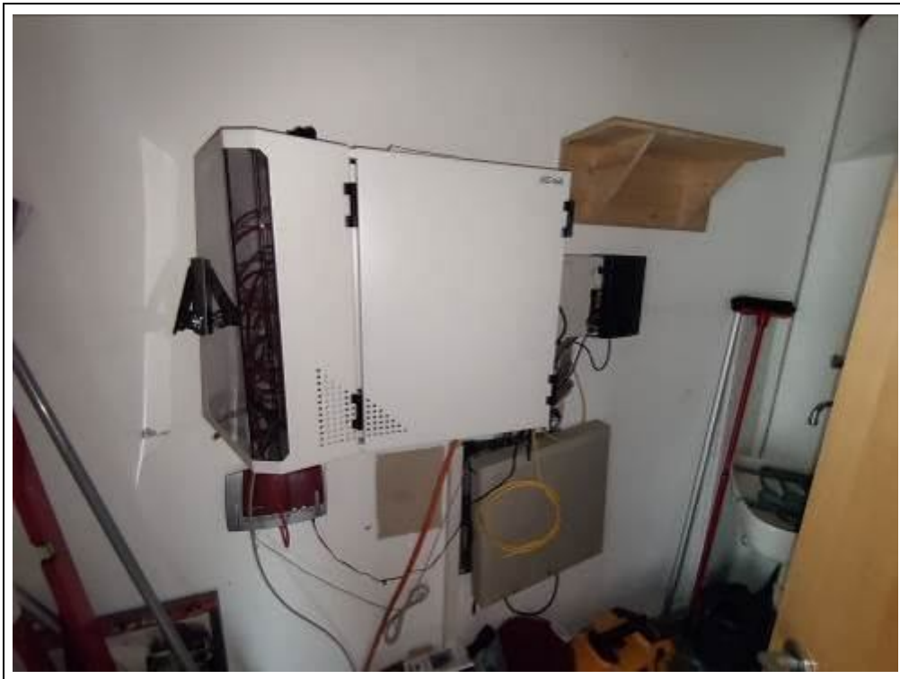
Blick in den Abstellraum mit Server
