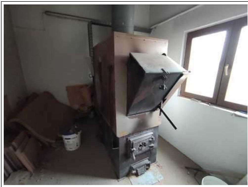
Blick auf die Heizungsanlage
