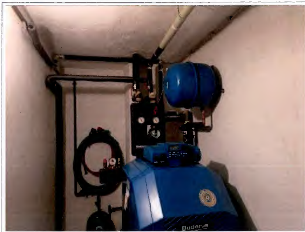
Blick auf die Heizungsanlage
