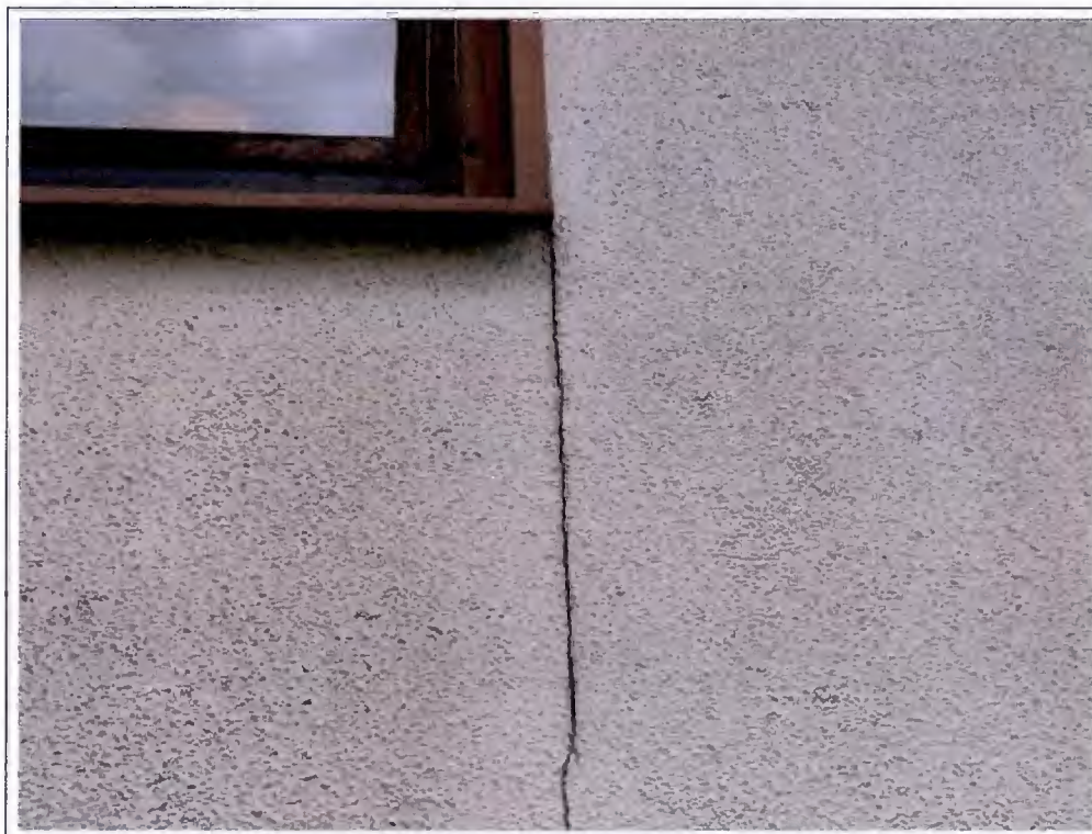
Blick auf einen Riss in der Fassade
