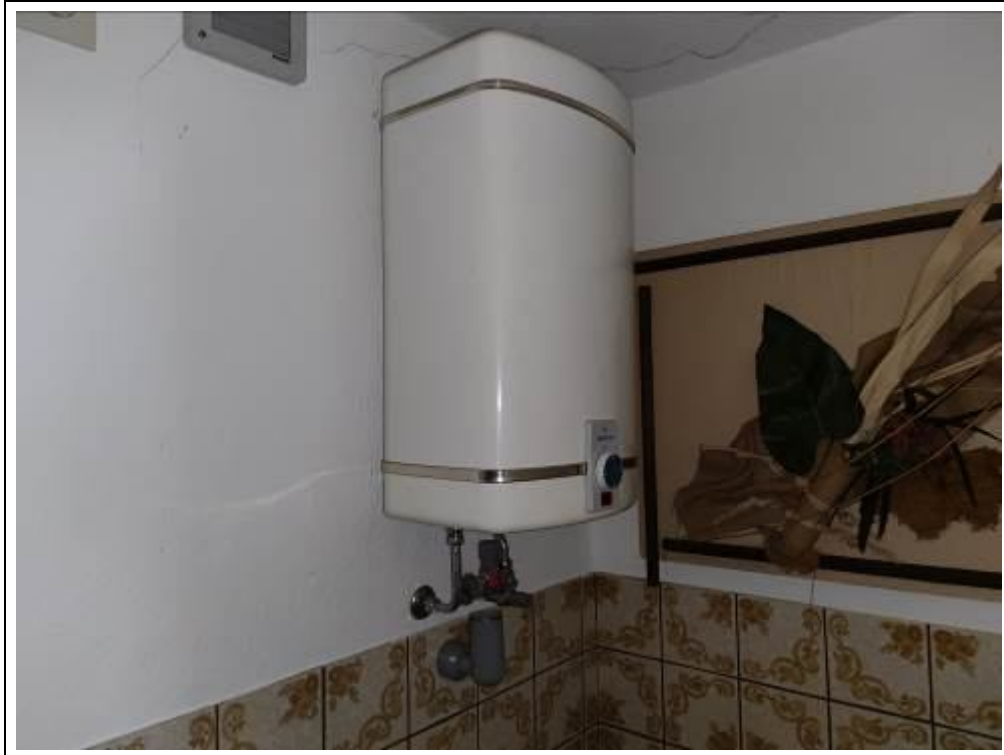
Blick auf den elektrischen Warmwasserboiler in der Dusche
