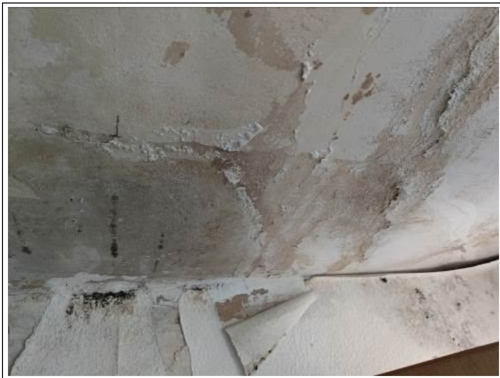
Blick auf einen Feuchte- und Schimmelpilzschaden im Dachgeschoss
