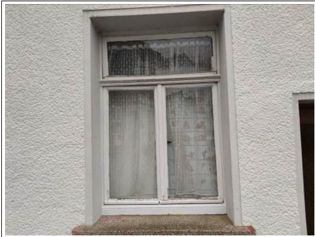
Blick auf kaputtes Holzfenster im Erdgeschoss
