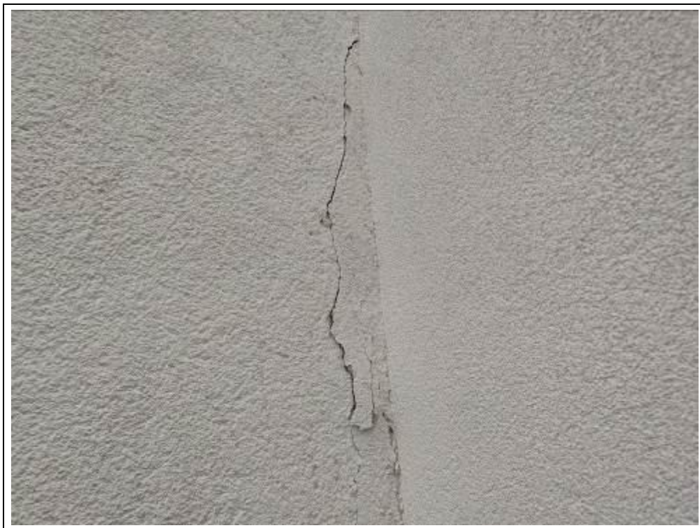
Blick auf kleinere Risse in den Außenwänden
