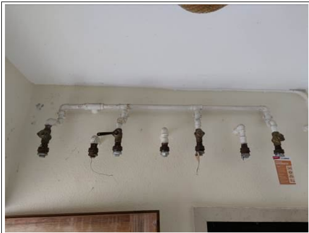
Blick auf die Gasverteilung im Eingangsbereich im Erdgeschoss
