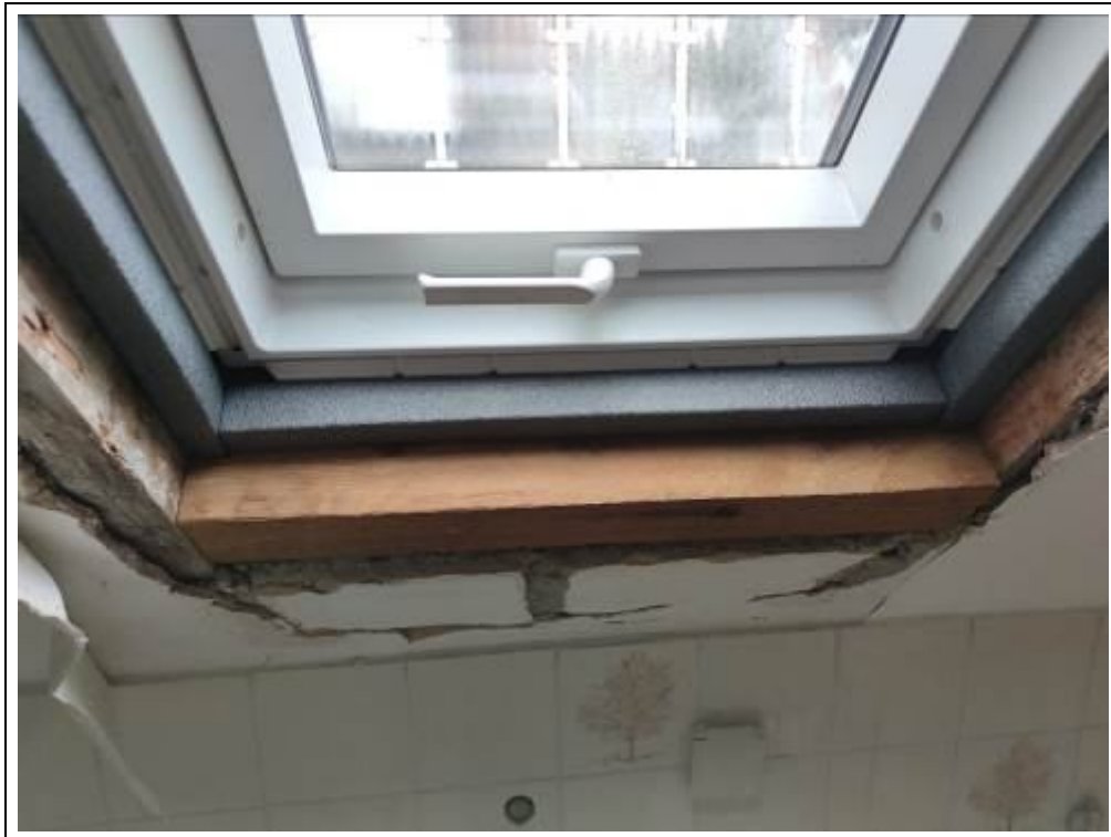
Blick auf den fehlenden Abschluss an einem Dachflächenfenster
