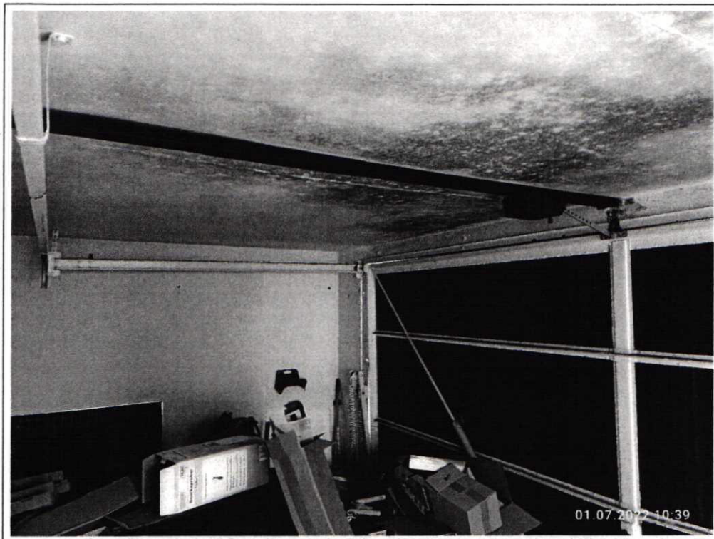
Leichter Schimmelschaden an der Decke der Garage
