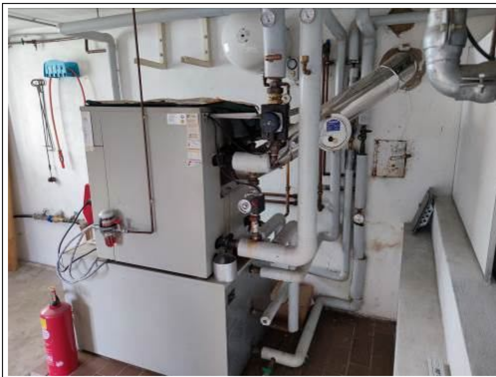
Blick auf die Heizungsanlage
