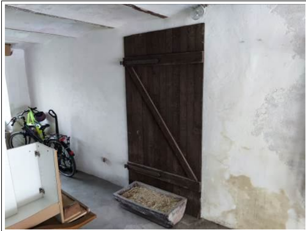
Blick in die Garage mit Zugang in die Scheune – keine Brandschutztüre
