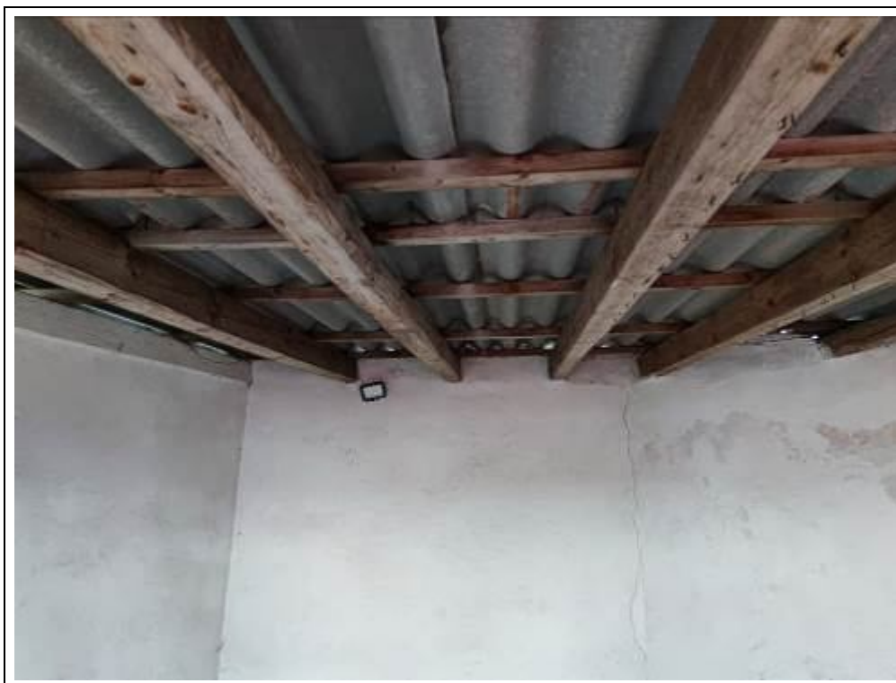
Blick in die Garage (riss in der Wand, Dacheindeckung aus Wellfaserzementplatten - asbesthaltig)
