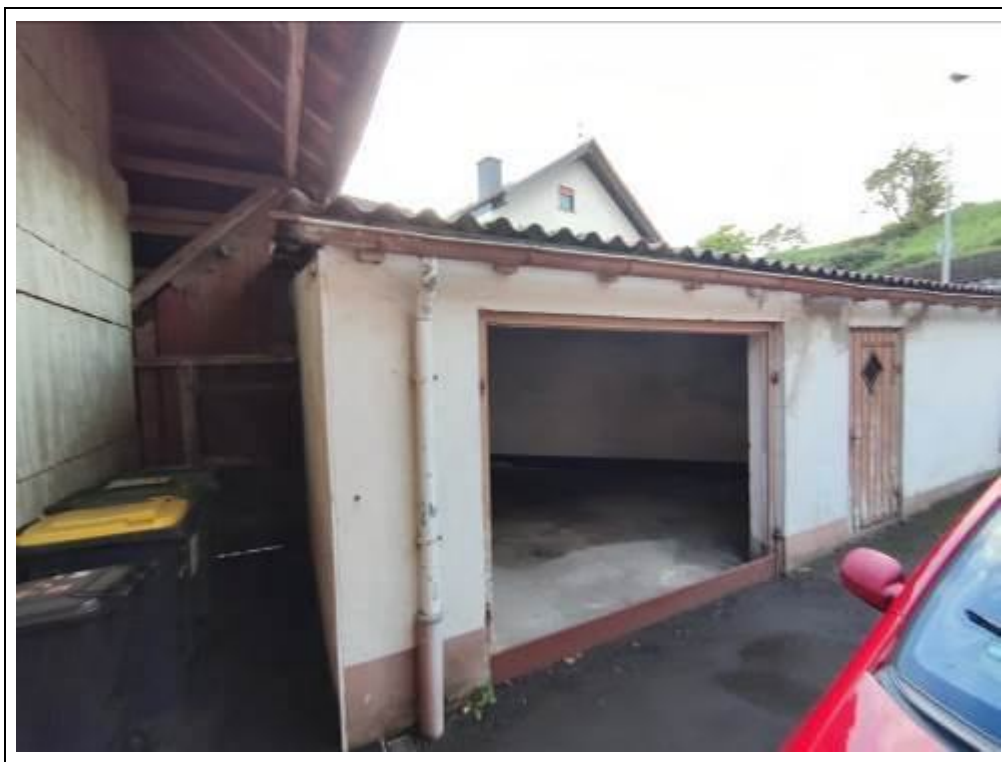
Blick auf die Garage von Nordosten (Garagentor fehlt)
