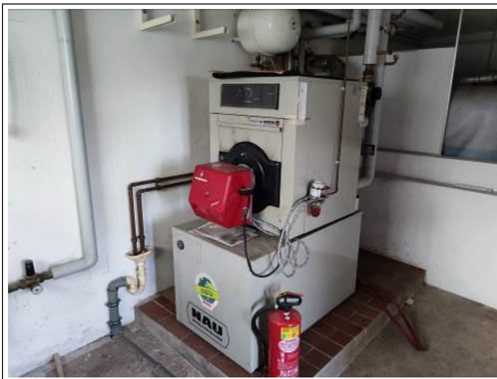
Blick auf die Heizungsanlage
