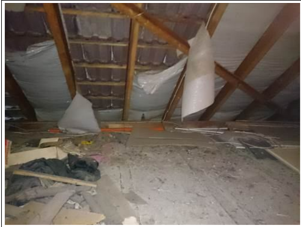
Fehlende Wärmedämmung im Spitzboden und im Dachgeschoss
