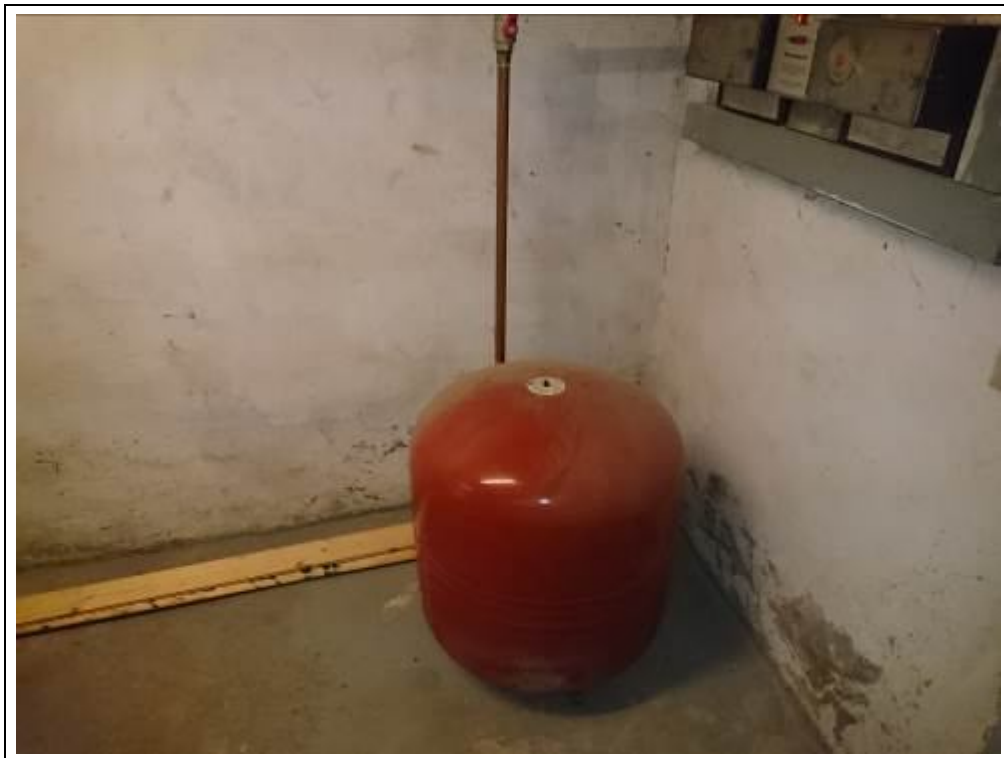
Feuchtigkeitsschäden an den Kellerwänden
