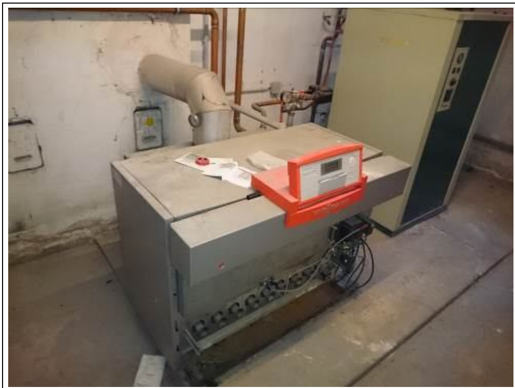
Blick auf die Heizungsanlage
