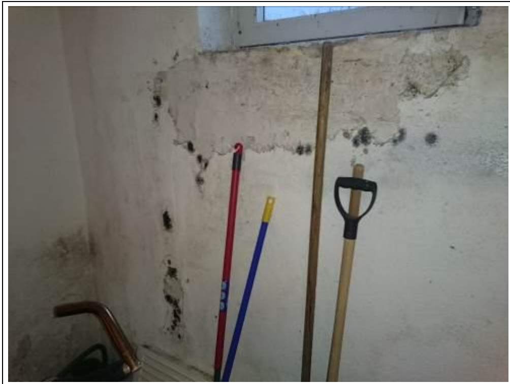
Feuchtigkeits- und Schimmelpilzbildung an den Außenwänden im Kellergeschoss
