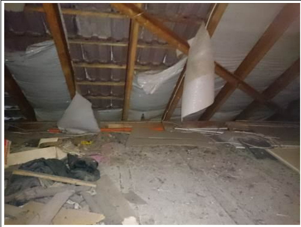
Fehlende Wärmedämmung im Spitzboden und im Dachgeschoss
