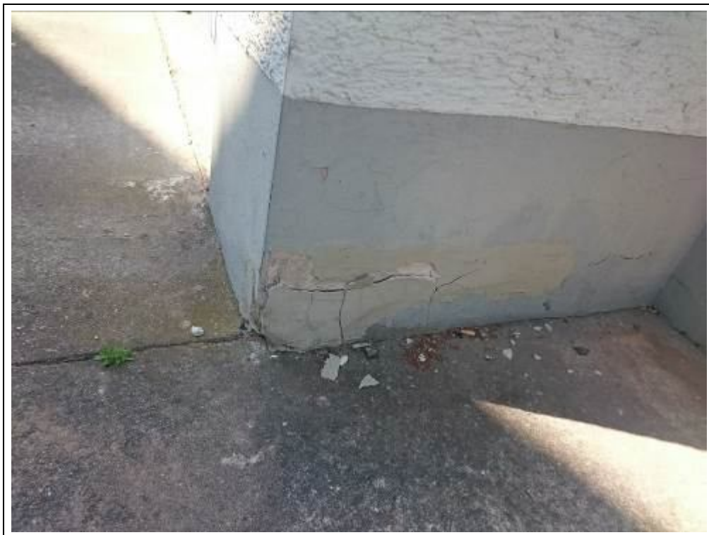
Schäden am Außenputz der Garagen
