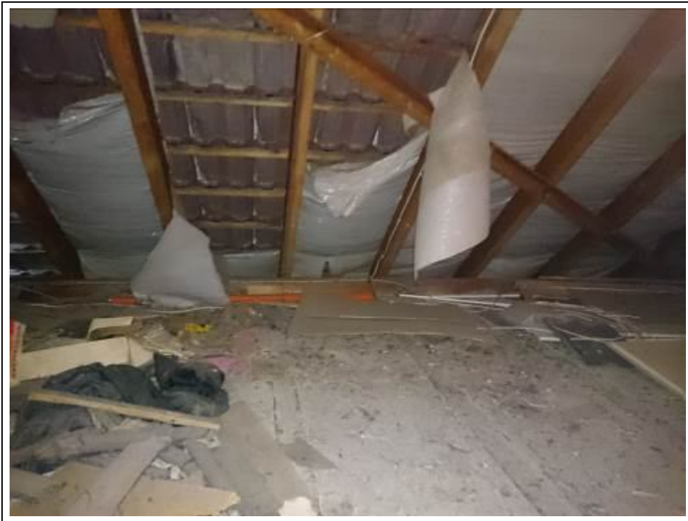
Fehlende Wärmedämmung im Spitzboden und im Dachgeschoss
