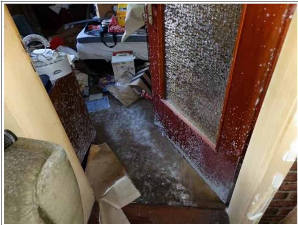
Blick vom Wohnzimmer ins Schlafzimmer it starken Schimmelpilzschäden
