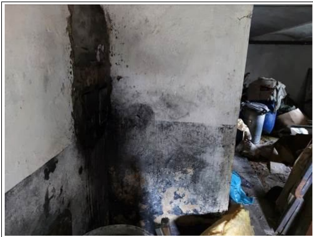
Blick auf Feuchtigkeitsschäden an den Kellerwänden
