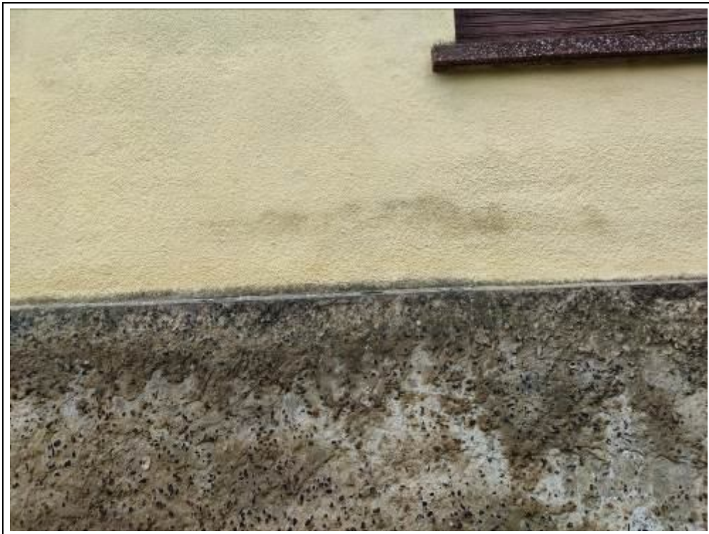
Blick auf Feuchtigkeitsschäden an der Außenwand
