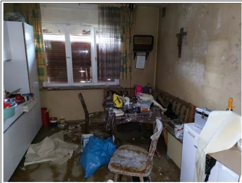
Blick in die Küche mit starken Schimmelpilzschäden
