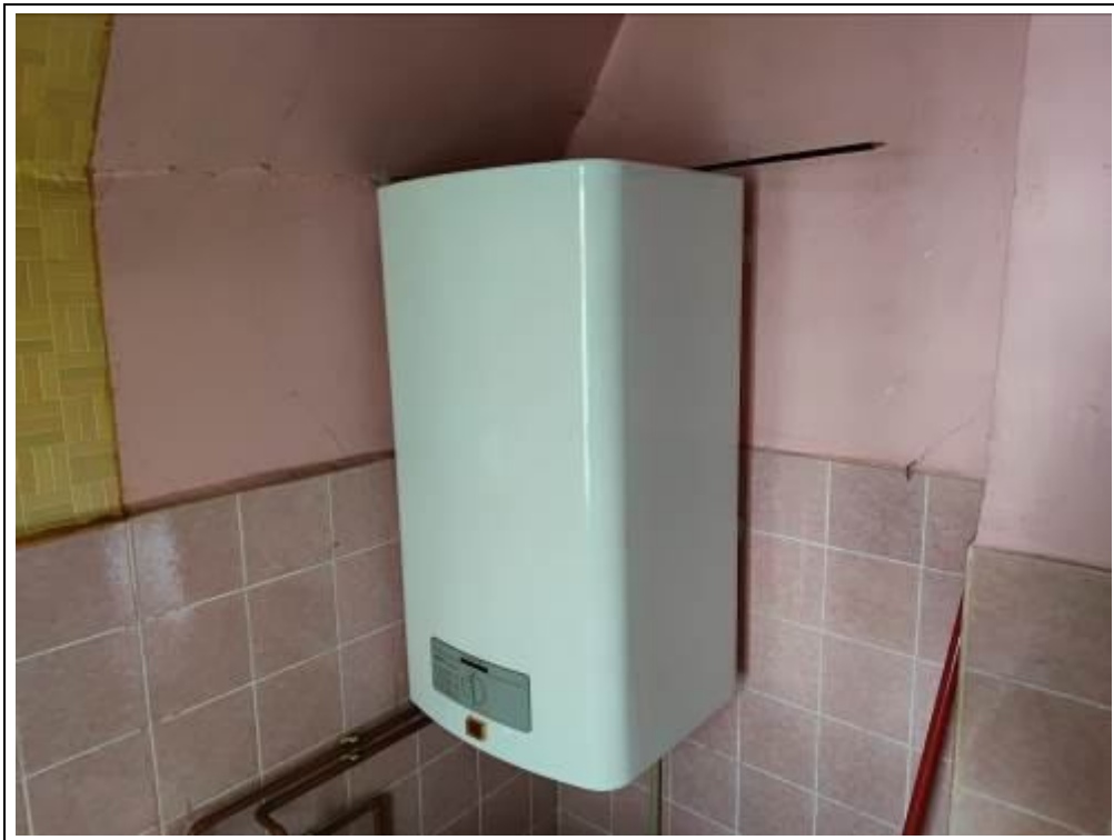
Blick auf den elektrischen Warmwassererzeuger im Bad Dachgeschoss
