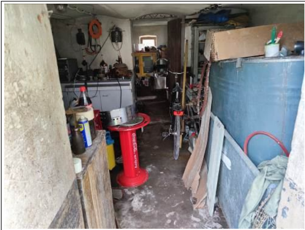
Blick in den Keller mit Heizöllagertank
