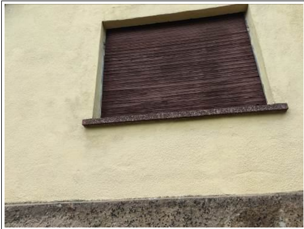
Blick auf den Zustand der Rollläden aus Holz
