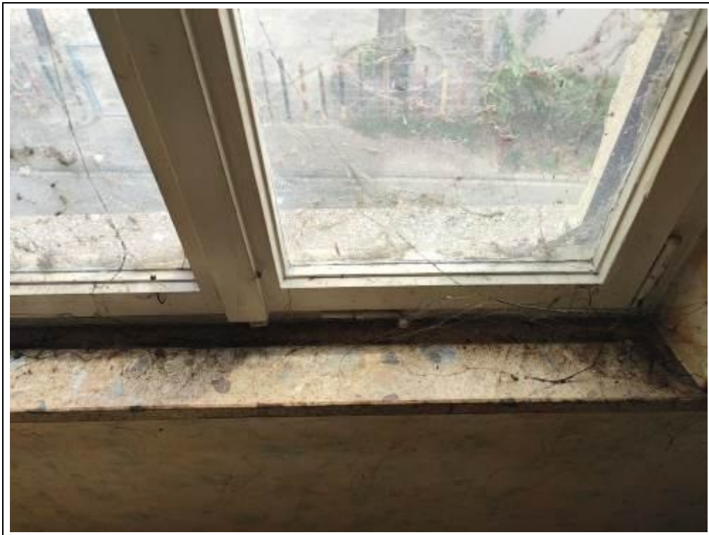
Blick auf den Zustand der Fenster mit Einscheibenglas
