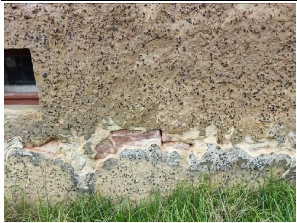
Blick auf Schäden am Außenputz
