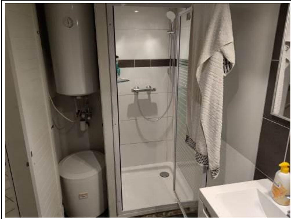
Blick in das Bad im Kellergeschoss mit elektrischen Warmwasserboiler
