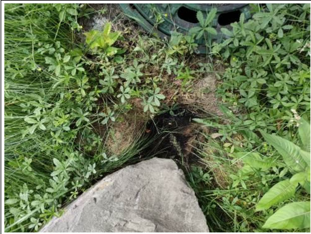
Blick auf den gebrochenen Revisionschacht
