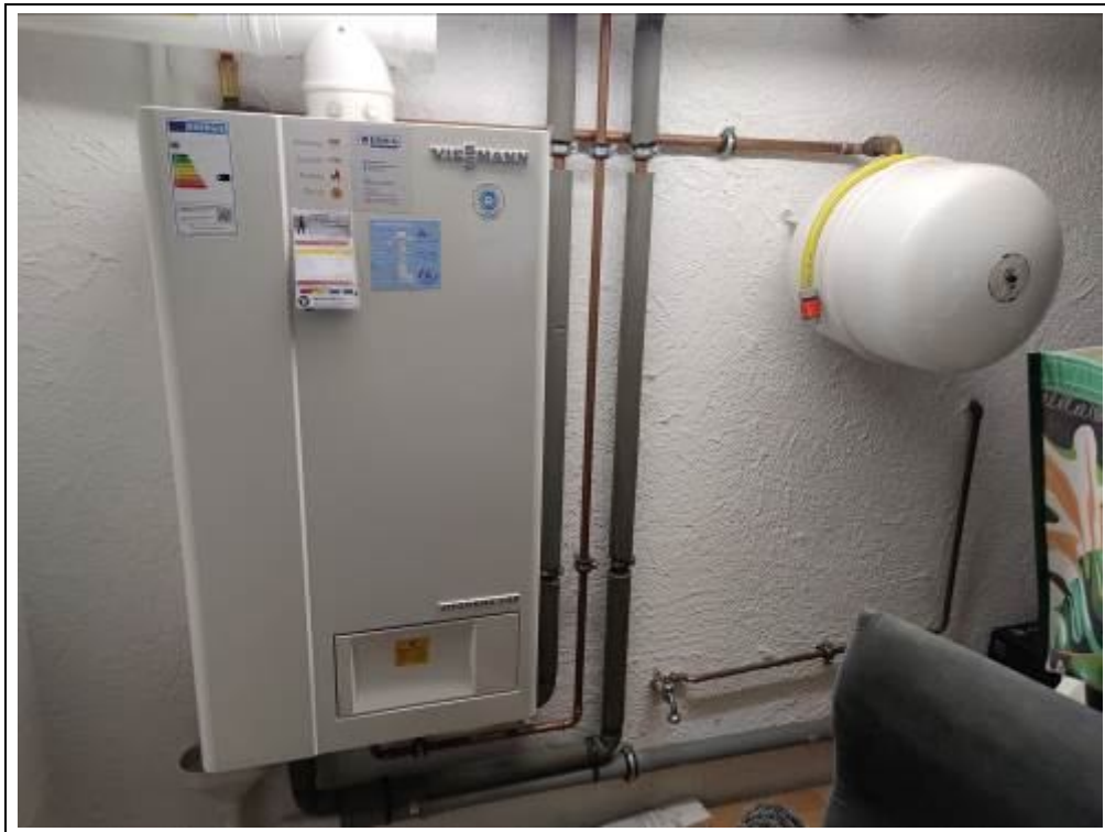
Blick auf die Gasheizung
