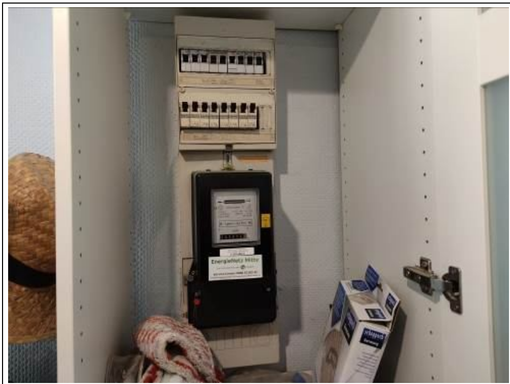
Blick auf die Unterverteilung und den Stromzähler
