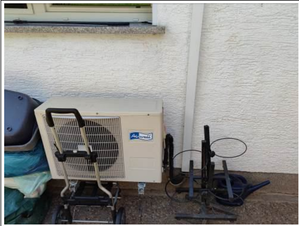
Blick auf ein Klimaaußengerät für das Schlafzimmer
