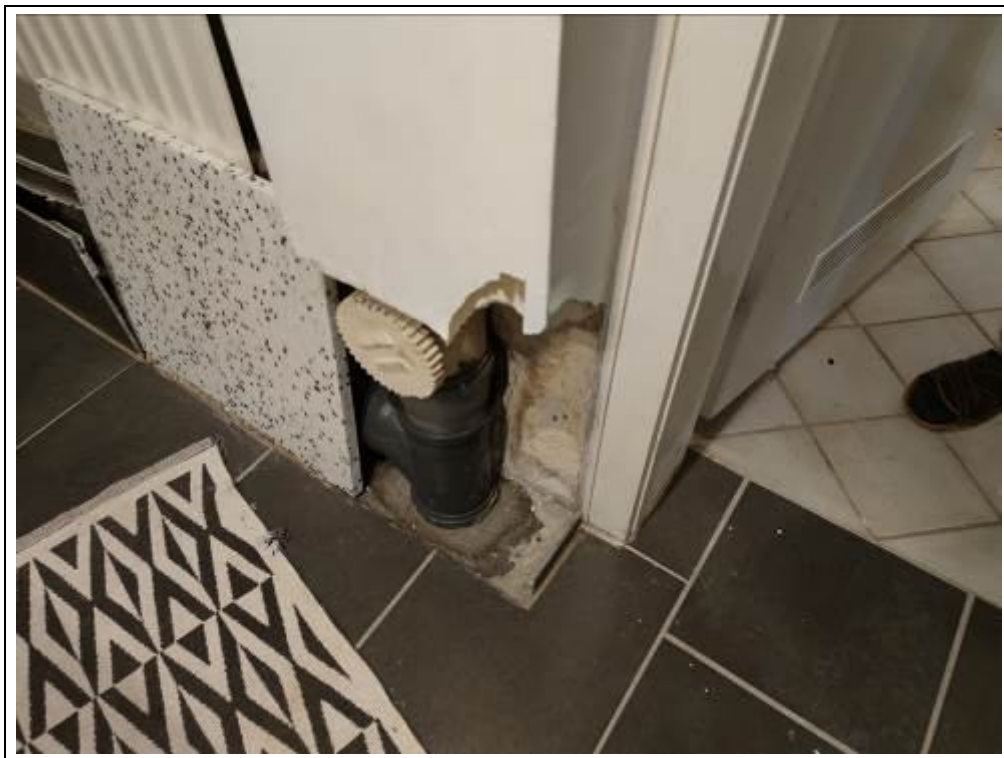
Blick auf den tlw. Behobenen Wasserschaden
