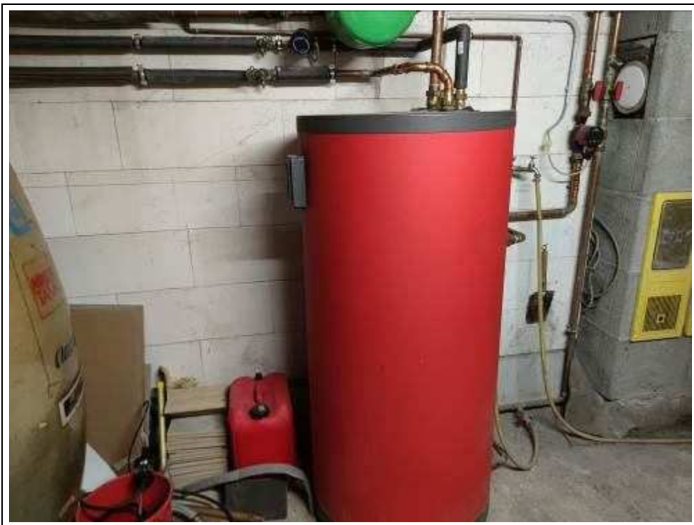
Blick auf den Warmwasserspeicher
