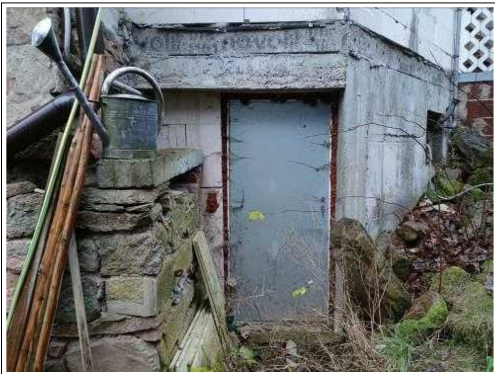
Blick auf den Zugang zum Tankraum von außen (wurde nicht genehmigt)
