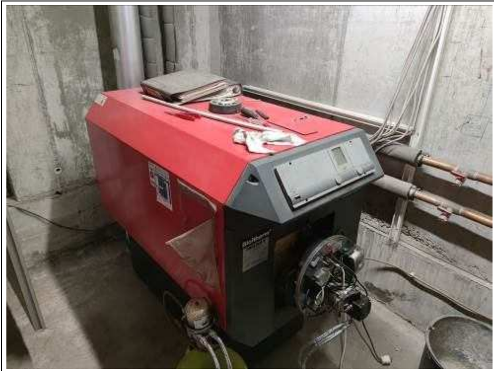
Blick auf die Heizungsanlage (zum Zeitpunkt des Ortstermins aufgrund von Heizölmangel nicht funktionsfähig)
