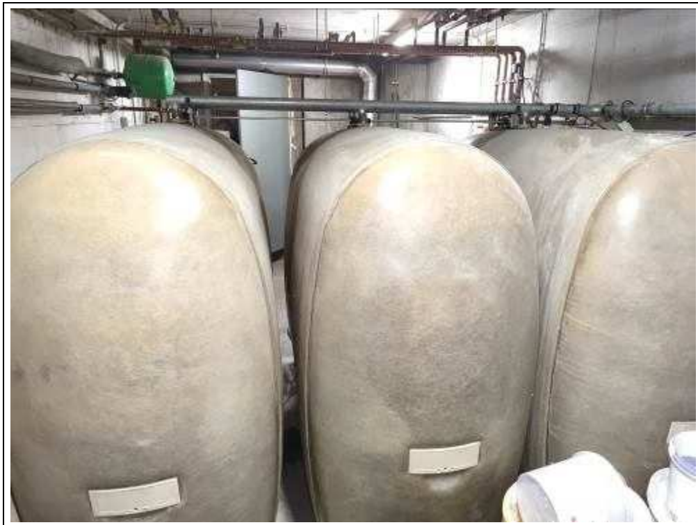
Blick auf die Heizöltanks
