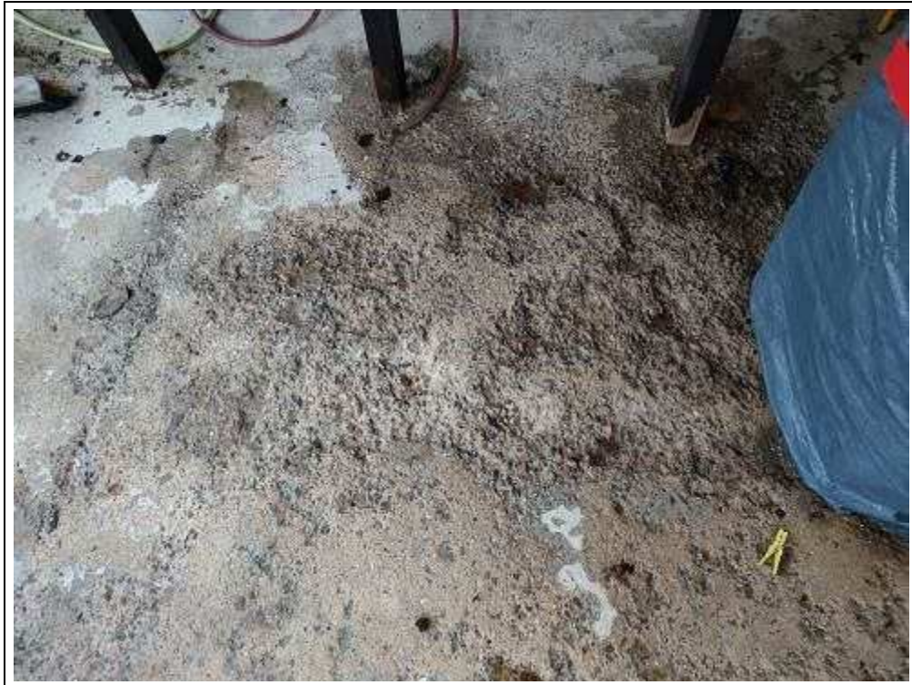
Blick auf den Zustand der Betonplatte auf dem Balkon
