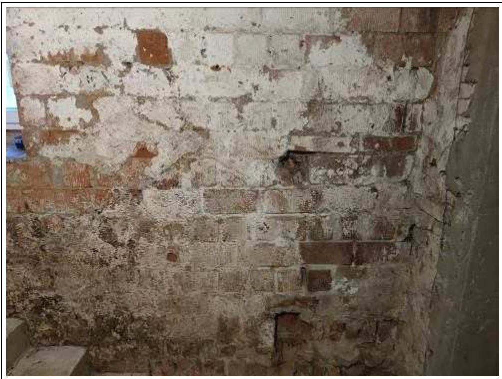
Blick auf den Zustand von alten Mauerwerk im Kellerbereich
