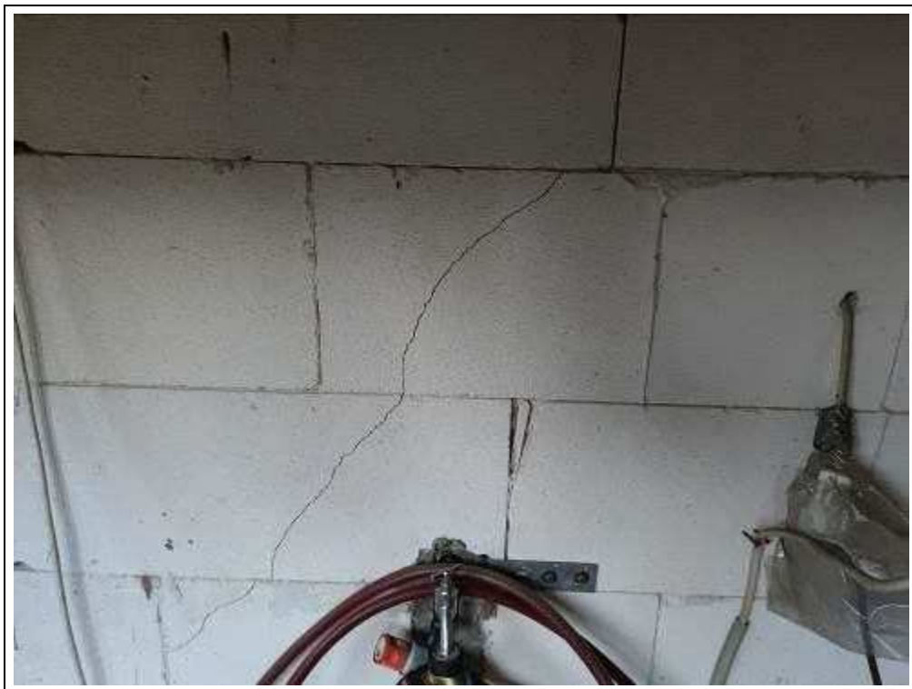
Blick auf einen Riss in der Außenwand
