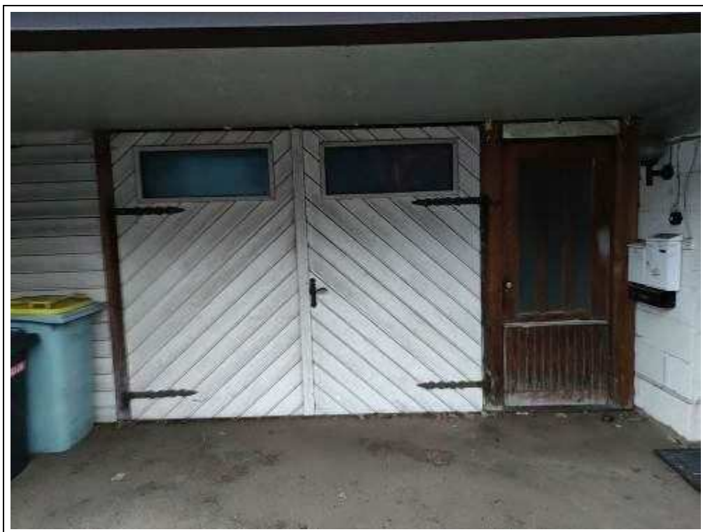
Blick auf das Zufahrtstor zum gemeinschaftlichen Kellerbereich
